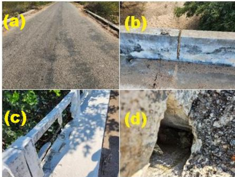
Figura 12 – Manifestações patológicas em instalações diversas
