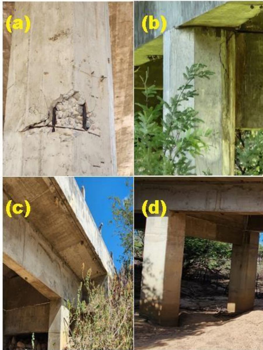
Figura 16 – Desplacamento, corrosão, fissura e lixiviação em pilares
