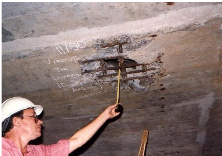
Figura 7 – Falha de concretagem
