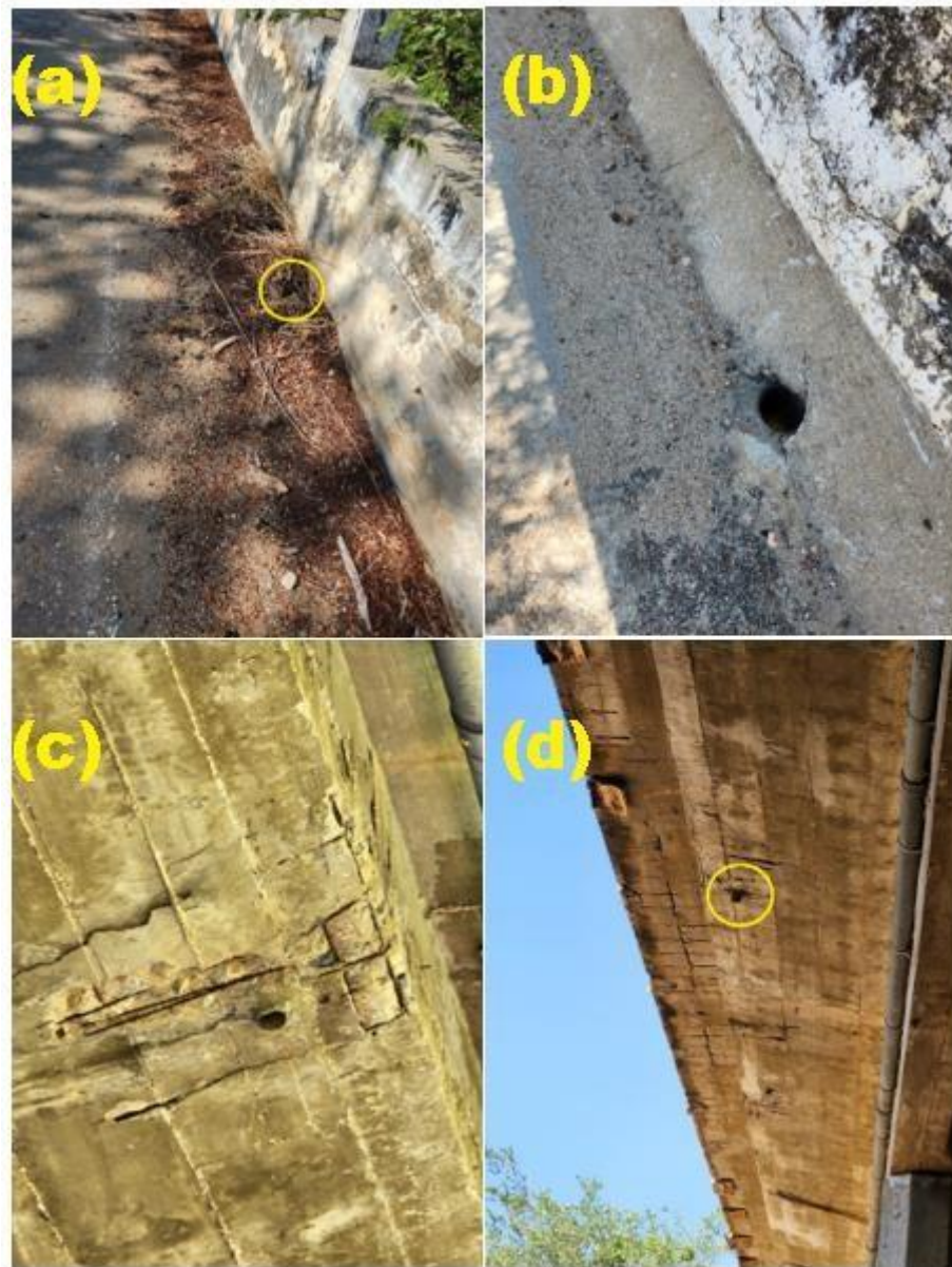
Figura 11 – Manifestações patológicas em instalações pluviais
