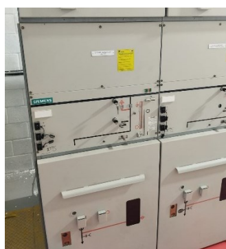
FIGURA 2. Visão frontal do painel elétrico mostrando a janela de inspeção. [Autoria própria]
