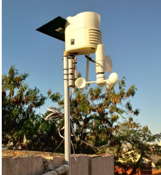
Figura 35 – Instalação do equipamento em campo.
