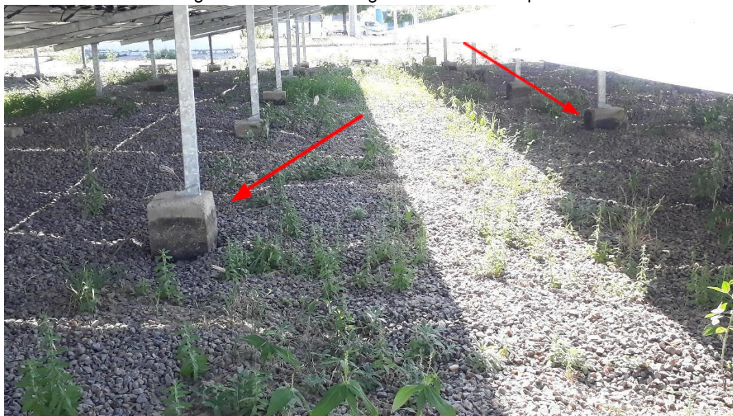
Figura 23 – Marca de água em blocos de apoio.
