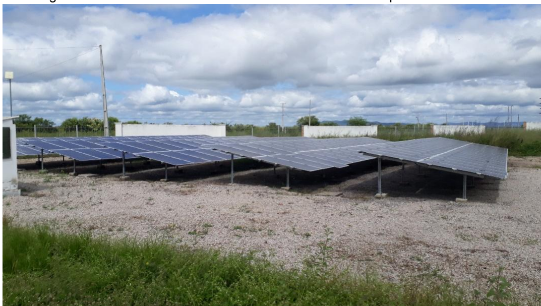
Figura 19 – Usina Fotovoltaica de chão da UFERSA - Campus Pau dos Ferros.
