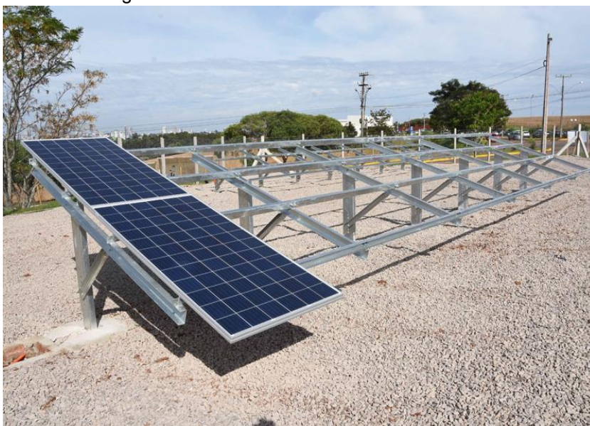
Figura 7 – Módulo fotovoltaico fixado em solo.
