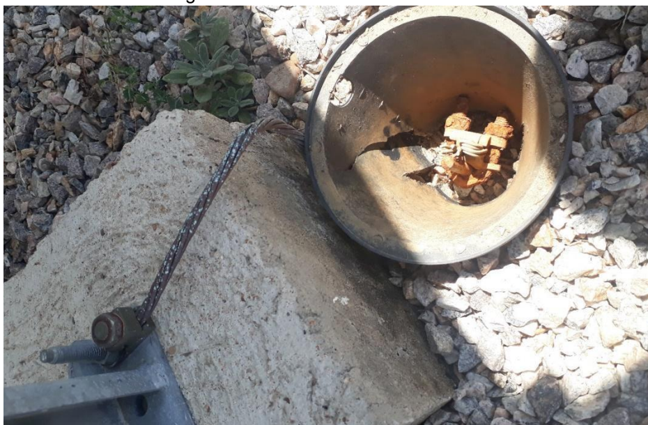
Figura 27 – Corrosão em aterramento.
