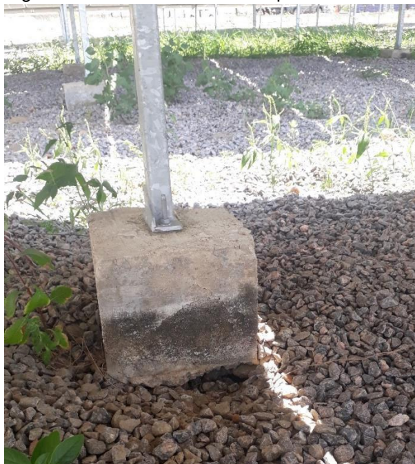
Figura 24 – Avaria em bloco de apoio de estrutura.
