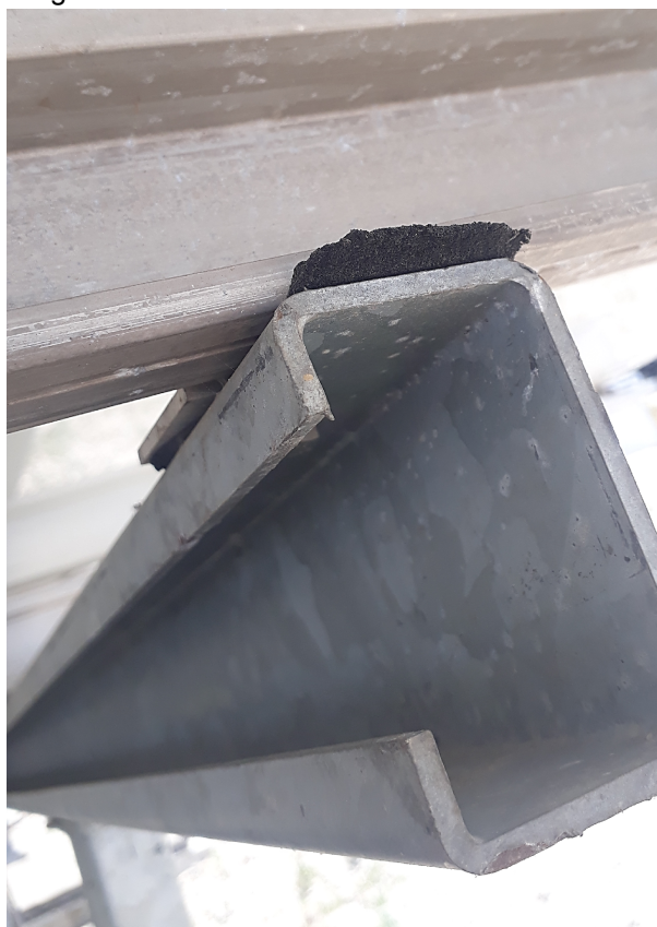
Figura 38 – Borracha ressecada entre estrutura.
