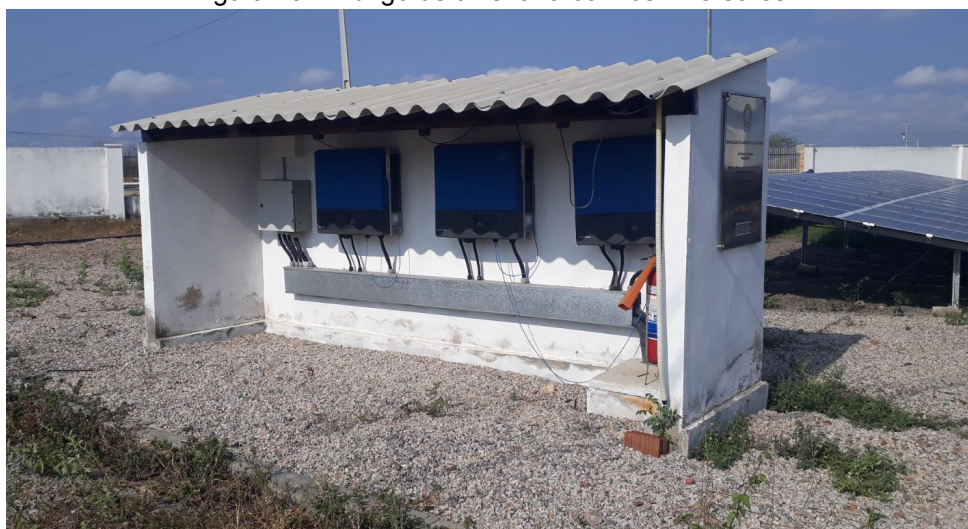
Figura 20 – Abrigo de alvenaria com os inversores.
