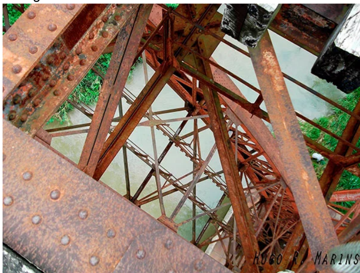
Figura 12 – Corrosão uniforme em estrutura metálica.
