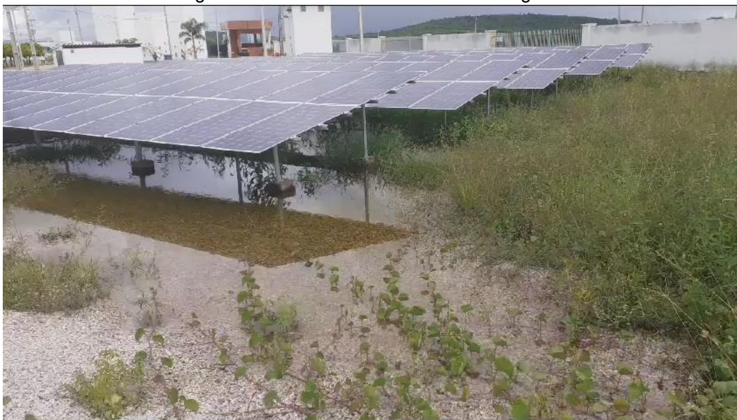
Figura 22 – Área da usina fotovoltaica alagada.
