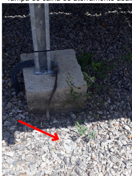
Figura 28 – Tampa de calha de aterramento abaixo do nível.
