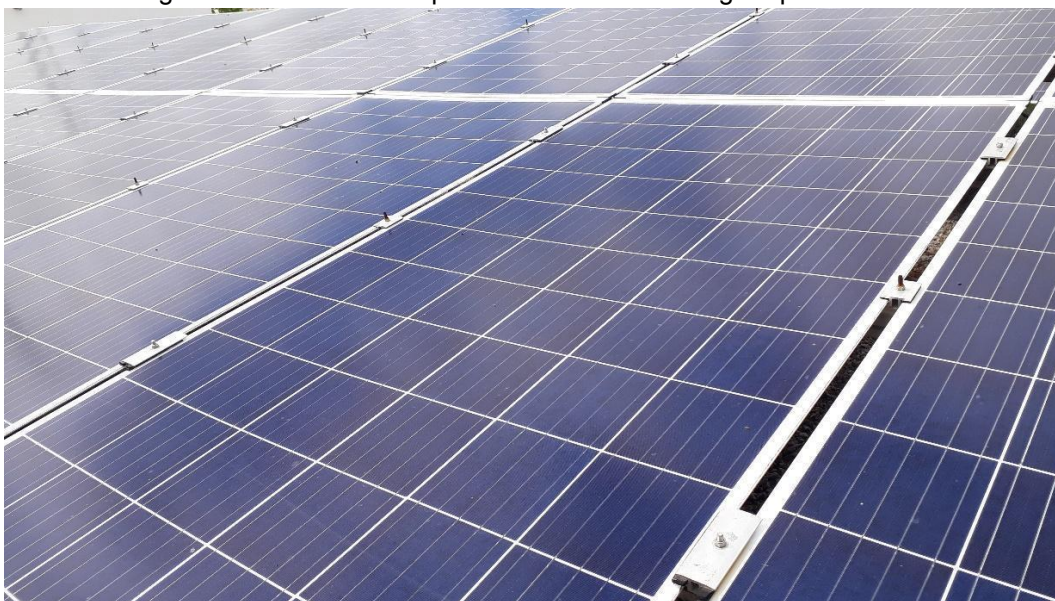
Figura 44 – Painéis com parafusos corroídos em grampos centrais.
