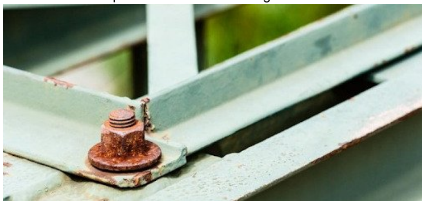
Figura 13 – Parafuso e porca sofrendo corrosão galvânica em estrutura metálica.
