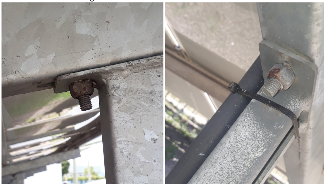
Figura 26 – Porcas com indícios de corrosão.
