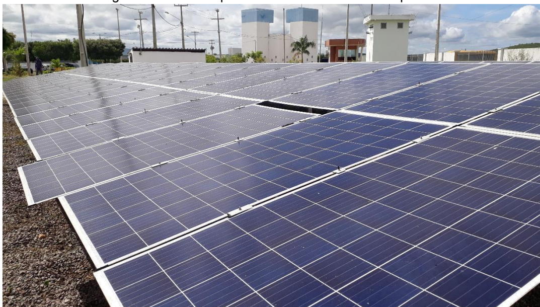
Figura 33 – Matriz apresentando deslizamento de painéis.
