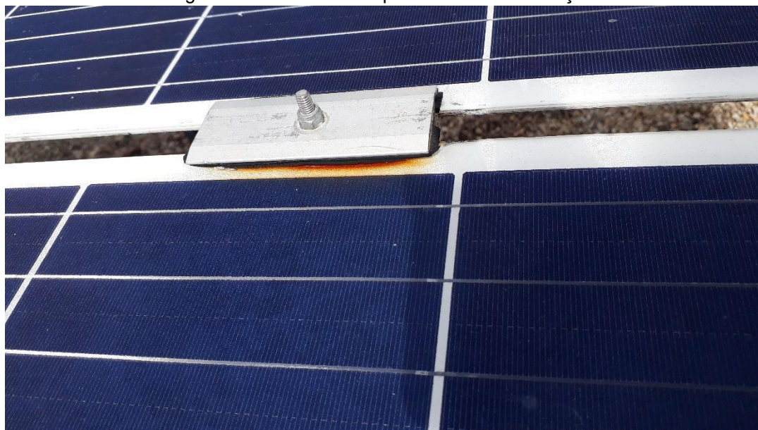
Figura 39 – Borracha em processo de deterioração.
