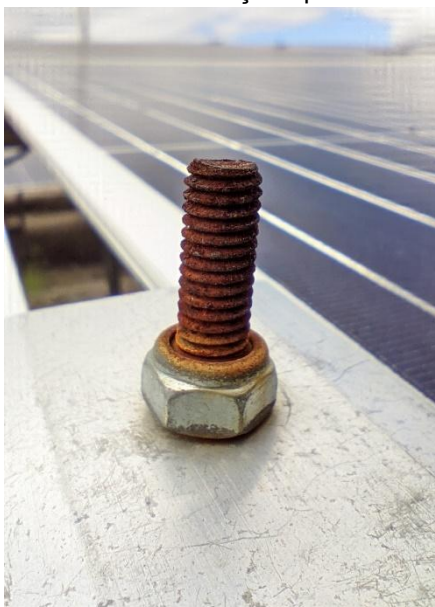
Figura 45 – Parafuso em avançado processo de corrosão.
