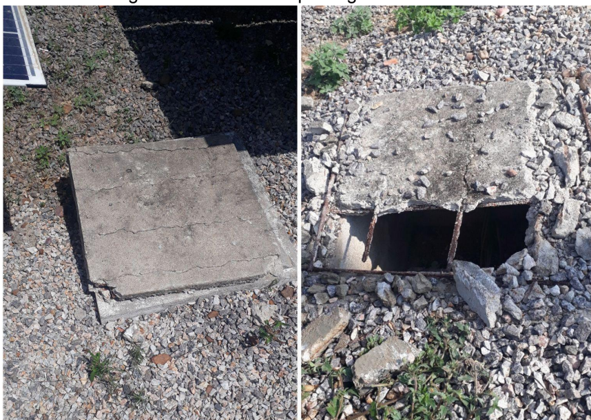
Figura 30 – Caixas de passagem danificadas.
