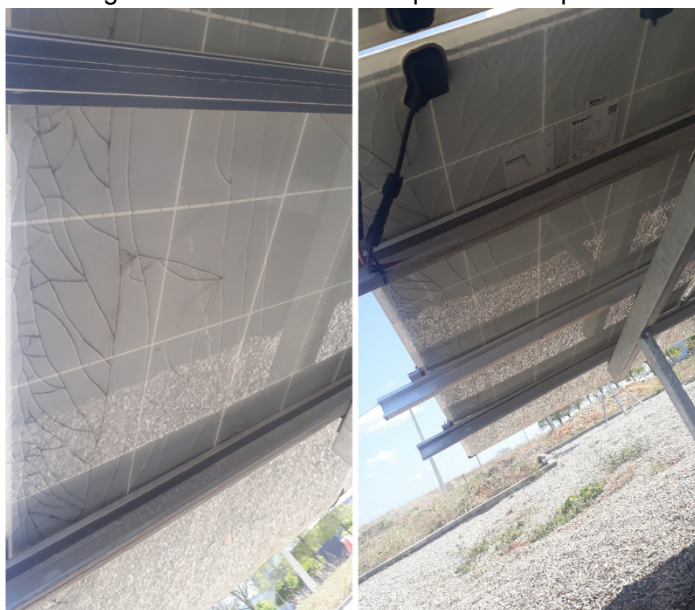
Figura 42 – Trincas na face posterior da placa.
