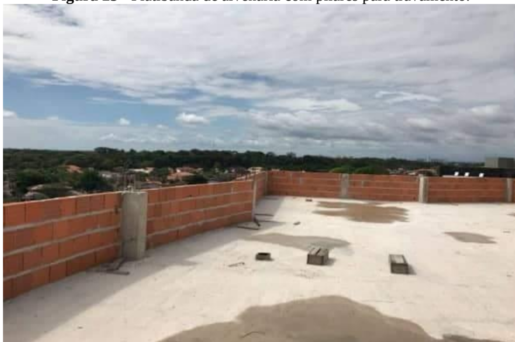
Figura 23 - Platibanda de alvenaria com pilares para travamento.
