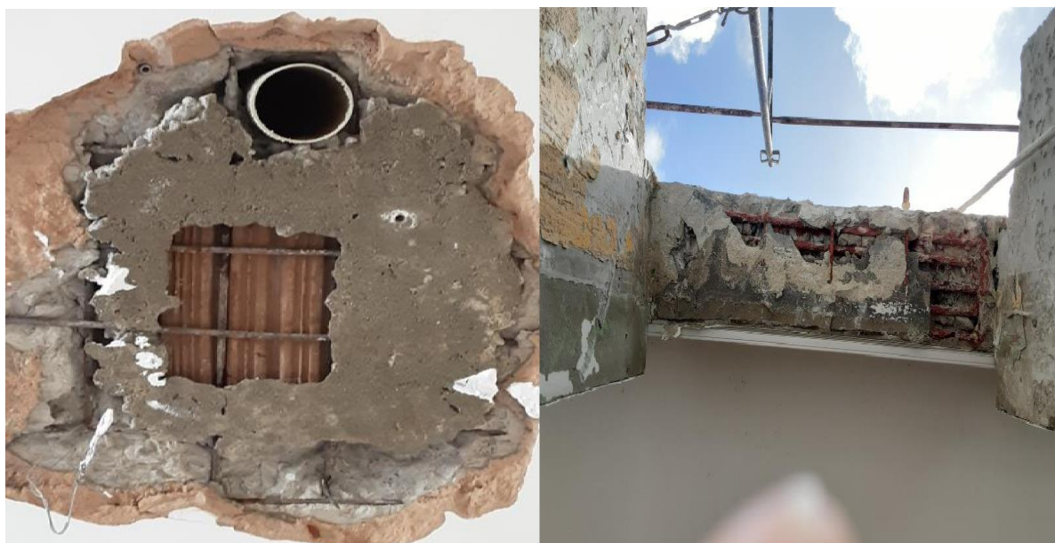
Figura 16 – Existência de ninhos (segregação) em lajes e em vigas.
