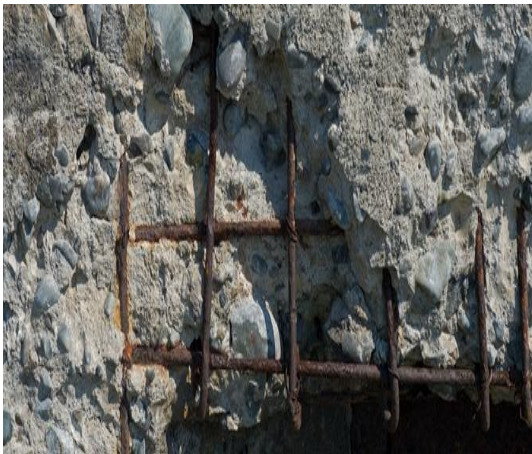
Figura 02 – Bicheira em estrutura de concreto armado.
