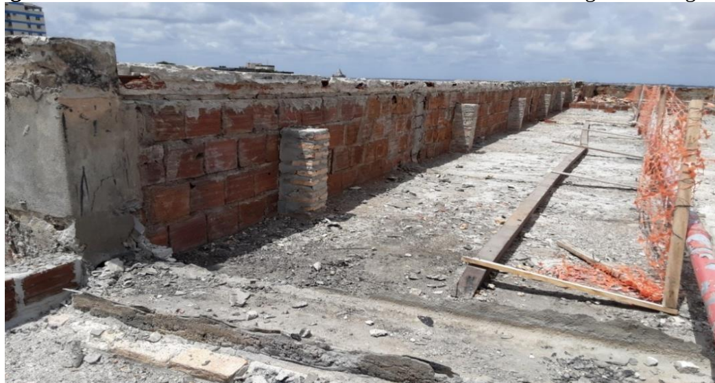
Figura 18 - Platibanda com ausência de travamento e com elevado grau de desgaste.
