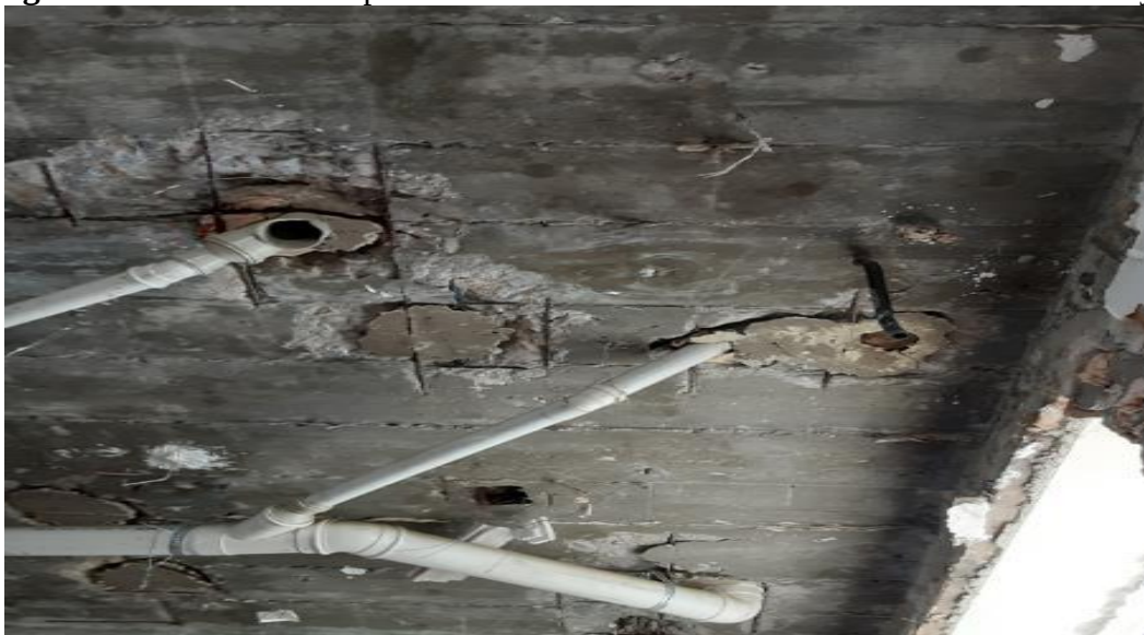
Figura 13 - Armaduras expostas e destacamento do concreto de cobertura em laje.
