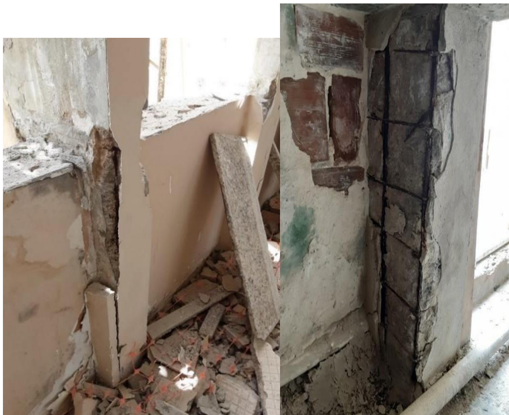
Figura 03 - Armaduras expostas e destacamento do concreto.
