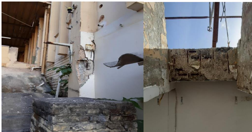
Figura 11 - Armaduras expostas e destacamento do concreto de cobrimento.
