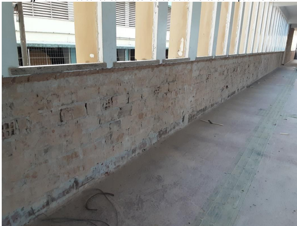
Figura 19 - Platibanda com ausência de travamento do 2º pavimento.
