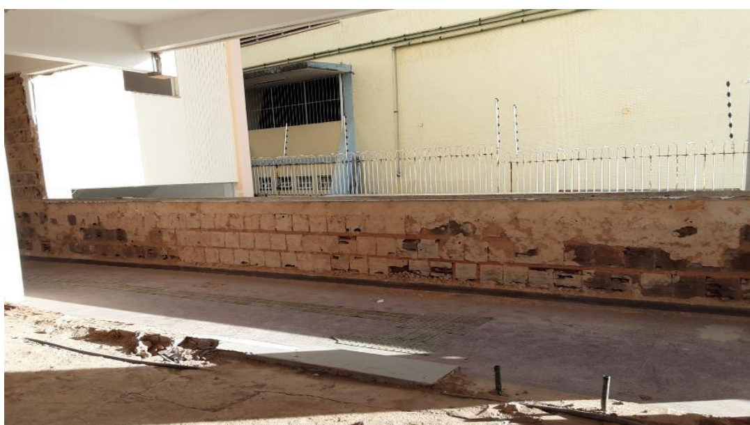
Figura 17 - Platibanda com ausência de travamento.
