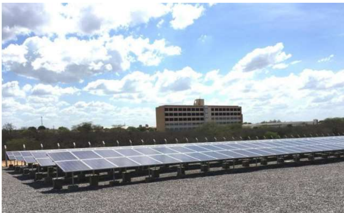
Figura 1 – Usina Solar Mossoró 02 – Campus Leste (UFERSA)
