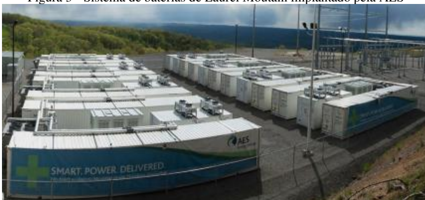
Figura 3 - Sistema de baterias de Laurel Mountain implantado pela AES
