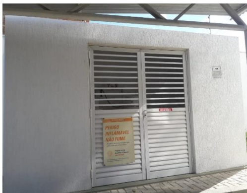
Figura 10- Central de gás liquefeito de petróleo (Autoria própria).
