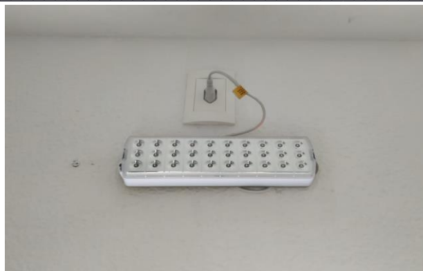
Figura 9- Iluminação de emergência (Autoria própria).
