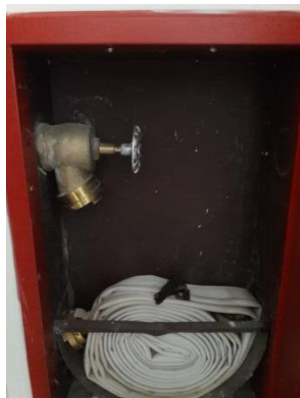
Figura 2 – Caixa do hidrante (Autoria própria).
