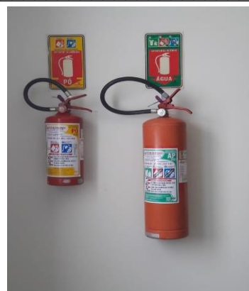
Figura 6- Conjunto de extintores (Autoria própria).
