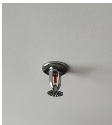
Figura 8 – Sprinkler (Autoria própria).
