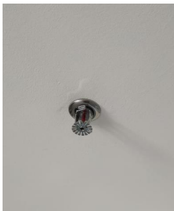
Figura 7 – Ponto de chuveiro (Autoria própria).
