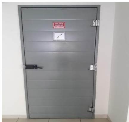
Figura 15- Porta corta-fogo (Autoria própria).
