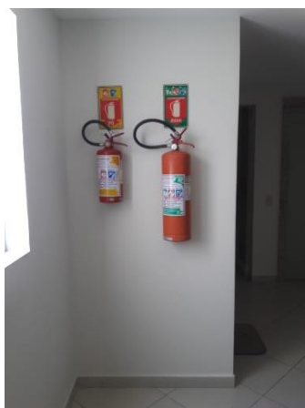
Figura 13- Extintores (Autoria própria).
