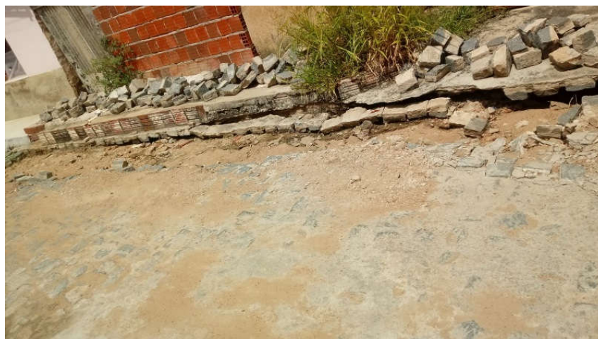
Figura 14 - Desgaste dos pavimentos.
