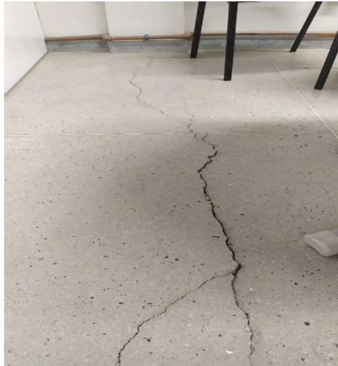
Figura 3: Patologia no piso
