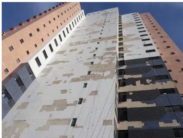
Figura 3. Descolamento de revestimentos cerâmicos.
