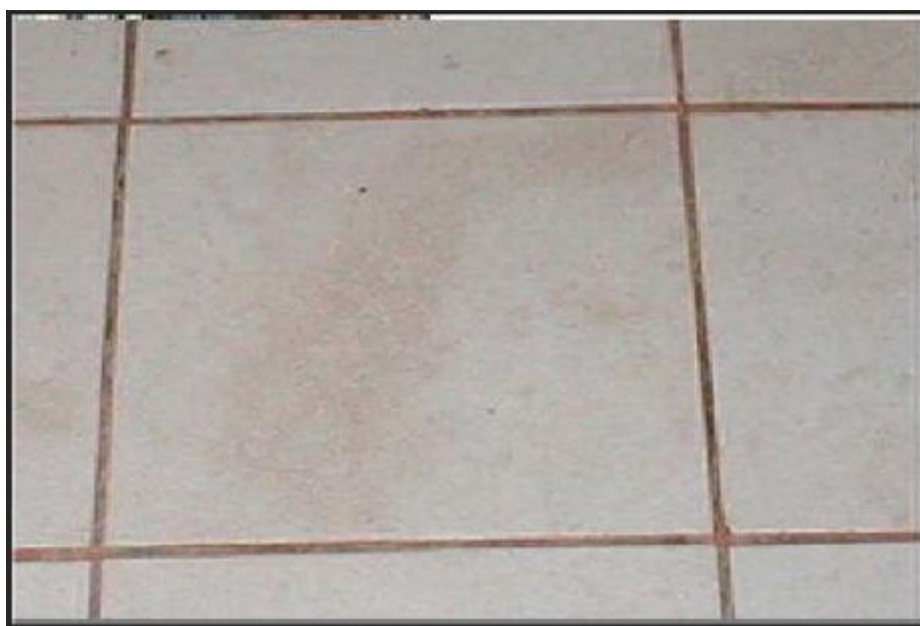
Figura 5. Bolor em Revestimento cerâmico
