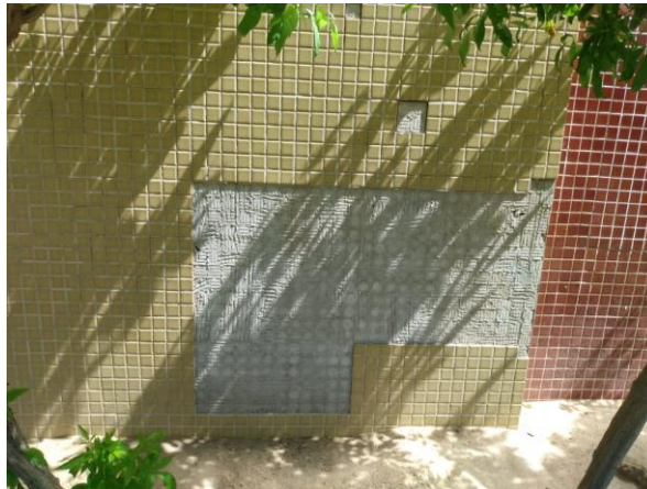
Figura 16. Detalhe de descolamento com verificação do tardo da pastilha
