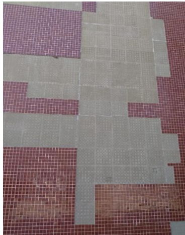
Figura 15. Detalhes do descolamento com inspeção nos cordões que foram desfeitos
