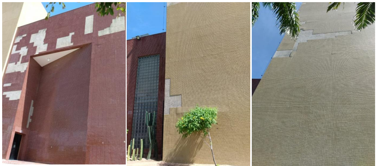
Figura 13. Destacamento das pastilhas cerâmicas. Fachada lateral esquerda
