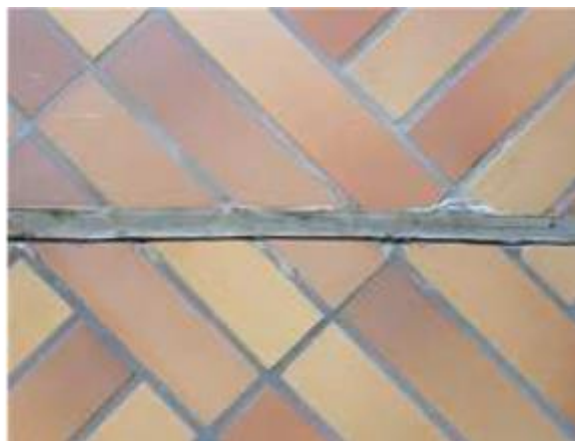
Figura 8. Deterioração das juntas
