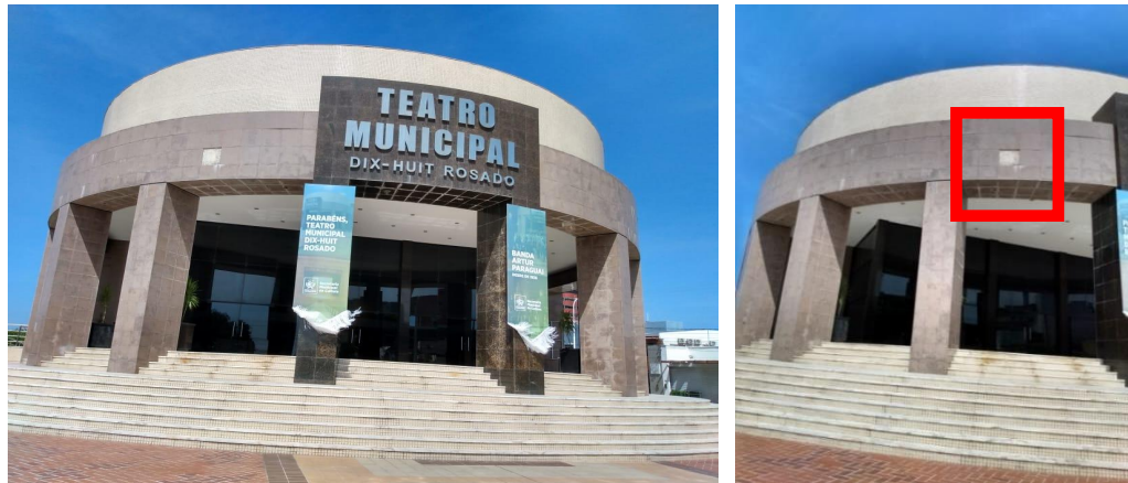
Figura 12. Destacamento do granito. Fachada principal
