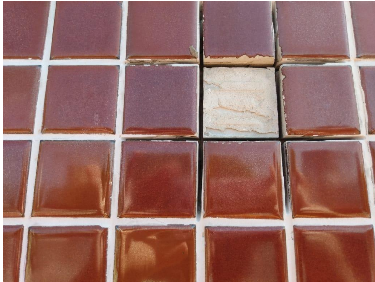
Figura 18: Descolamento da pastilha cerâmica
