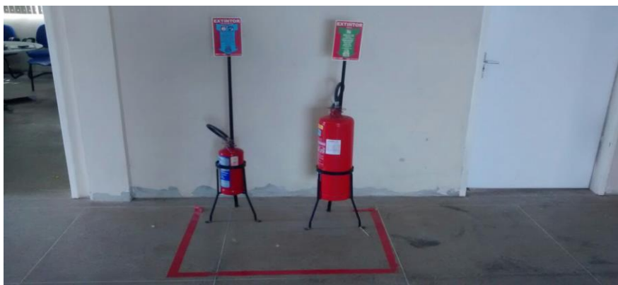
Figura 12. Extintores da fábrica de ração. Fonte: Autor
