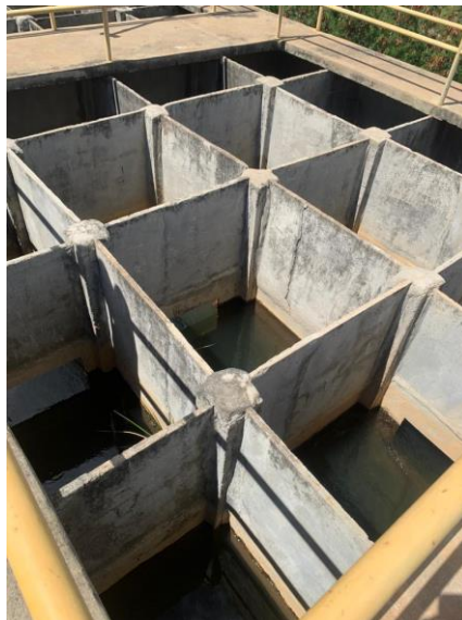
Figura 11 - Tanque de floculação.
