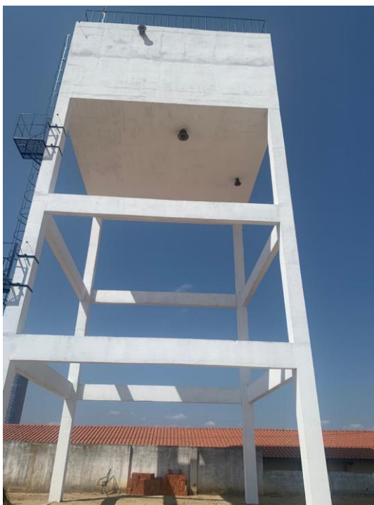
Figura 23 - Reservatório elevado para o atendimento ao bairro Expedito Diógenes.
