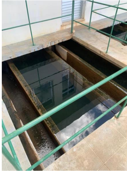
Figura 12 - Um dos quatros filtros existentes na ETA.
