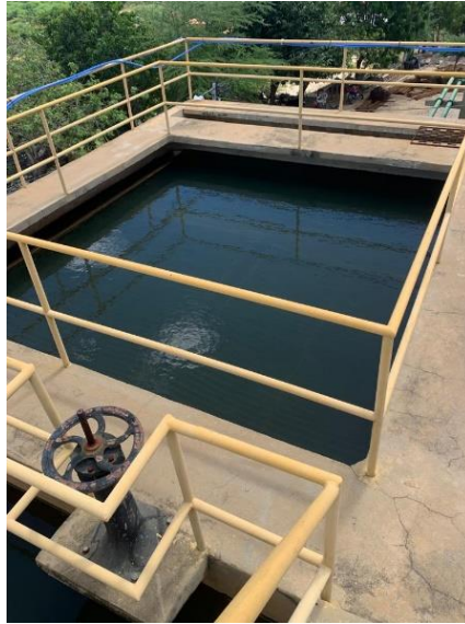
Figura 10 - Um dos dois decantadores existentes.
