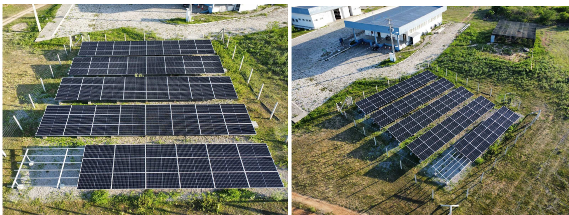
Figura 15 - Fotografias do arranjo de placas solares da usina de solo do Campus Angicos.
