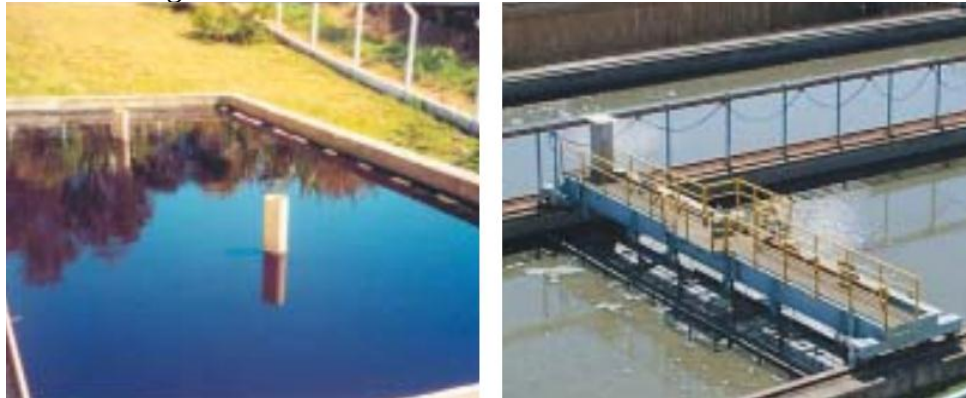
Figura 8: Decantador e decantador mecanizado
