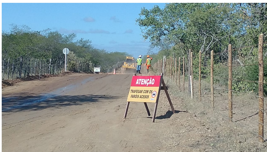
Figura 11: Sinalização Homens Trabalhando
