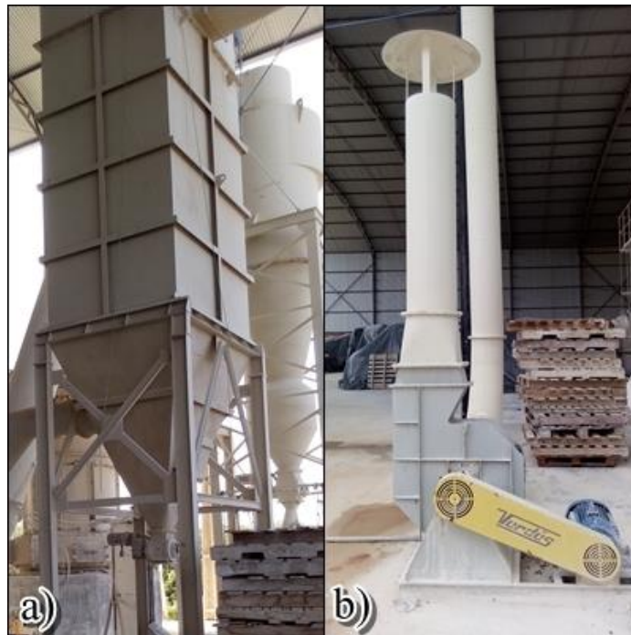
Figura 10. a) Filtro de mangas com boca de descarga de material fino; b) Ventilador secundário ligado a chaminé. (Fonte: Mineração Ouro Branco LTDA, 2012)
