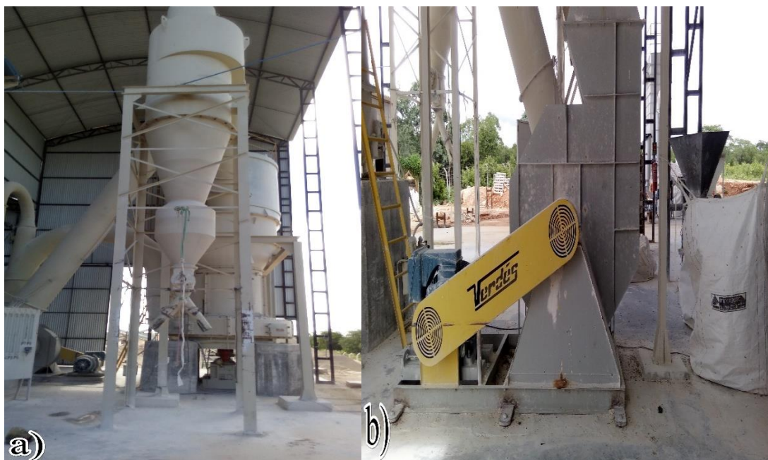
Figura 8. a) Ciclone e boca de alimentação; b) Ventilador principal. (Fonte: Mineração Ouro Branco LTDA, 2012)
