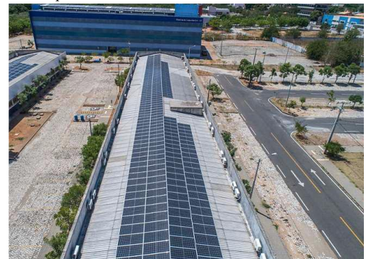
Fig. 11. Vista superior da Usina Solar Mossoró VII.
