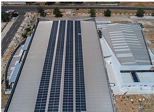
Fig. 9. Vista superior das Usinas Solares Mossoró V e VI de 185,65 kWp – campus Mossoró.
