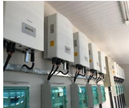
Fig. 3. Inversores trifásicos da Usina Solar Mossoró II.
