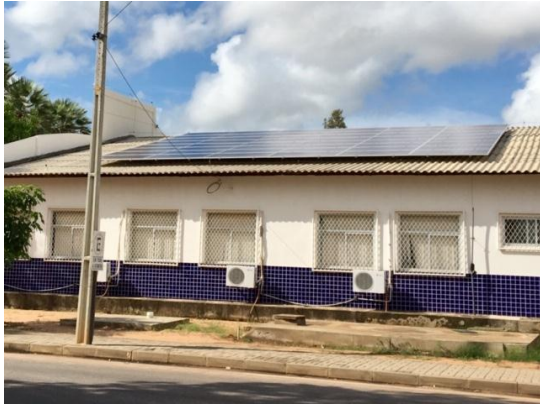
Fig. 4. Usina Solar Mossoró III de 15,6 kWp – campus Mossoró.
