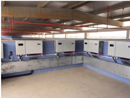
Fig. 8. Inversores trifásicos da Usina Solar Mossoró IV.
