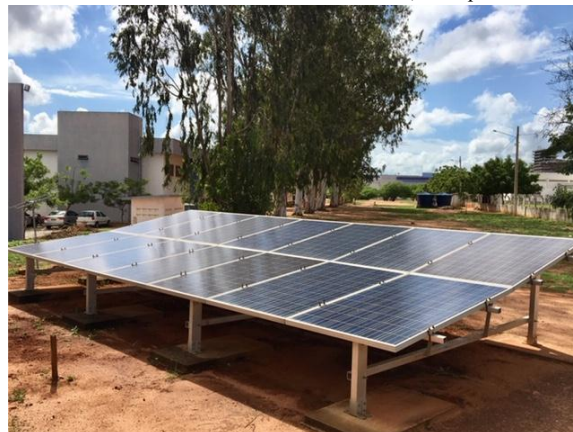
Fig. 1. Mini usina solar fotovoltaica Mossoró I de 3,43kWp.
