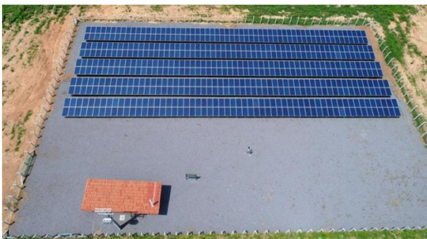
Fig. 2. Vista superior da Usina Solar Mossoró II de 150,8 kWp – campus Mossoró.
