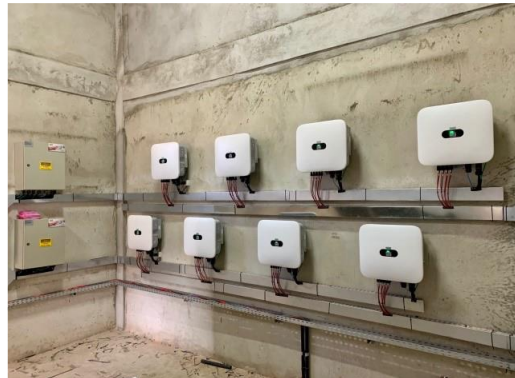
Fig. 10. Inversores trifásicos das Usinas Solares Mossoró V e VI.
