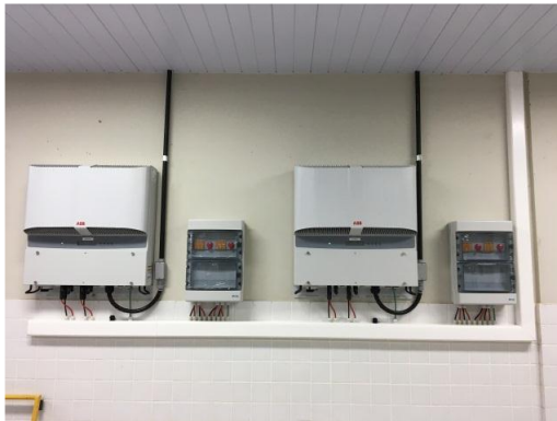
Fig. 5. Inversores trifásicos da Usina Solar Mossoró III.
