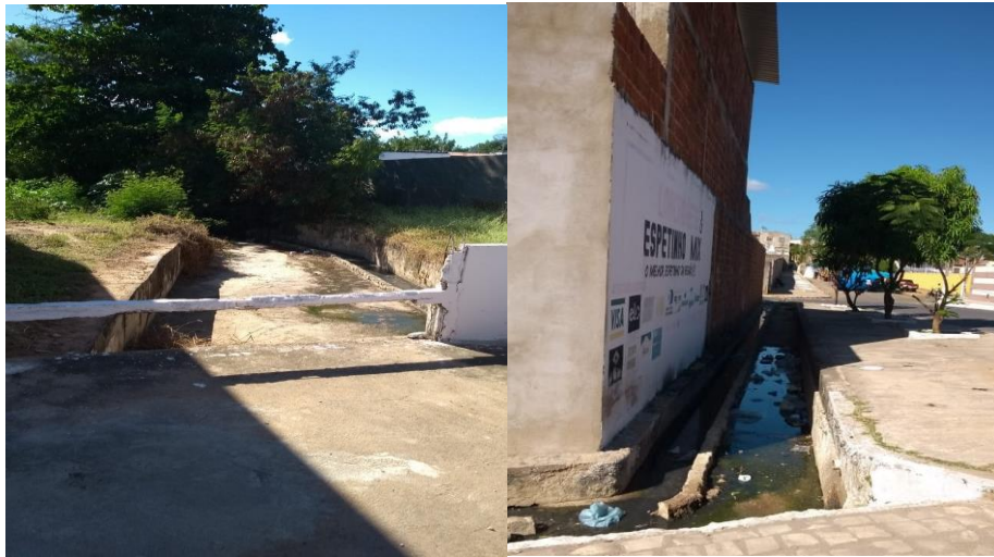
Figura 25 - Esgoto a céu-aberto nas Ruas: Prof. Basilio e Antonio H. Filho
