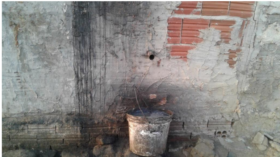
Figura 27 - Esgoto de uma residência na Zona Rural de Campo Grande/RN
