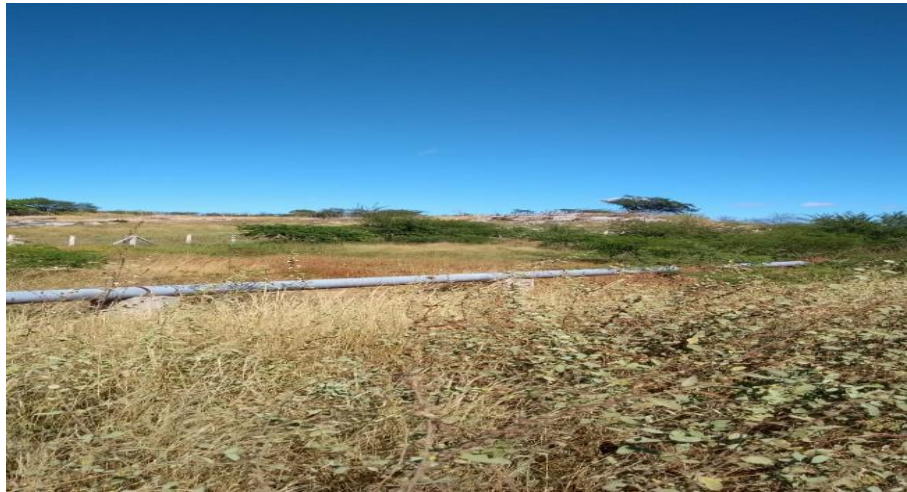
Figura 12 - Trecho da Adutora do Médio Oeste
