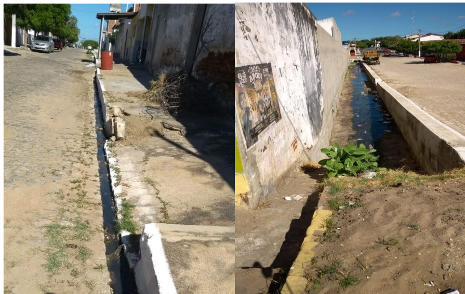
Figura 26 - Esgoto a céu-aberto nas Ruas: Veterano F. Vicente e Pedro Chaves
