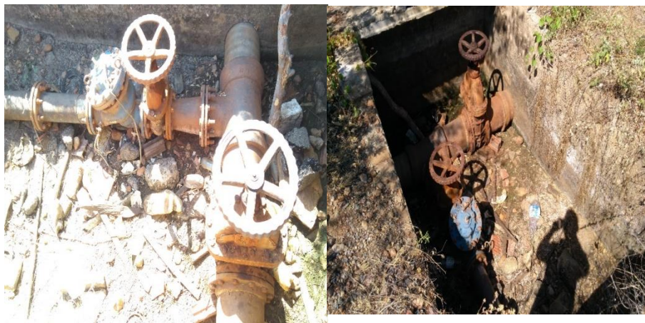
Figura 13 - Registro da Adutora do Médio Oeste
