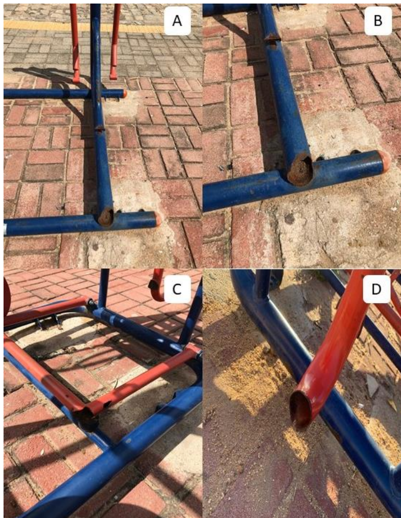
Figura 15: A) Simulador de caminhada com corrosão por esfoliação e em torno do cordão de solda. B) Estrutura com corrosão por esfoliação. C) Aparelho com corrosão por esfoliação. D) Peça com corrosão em torno do cordão de solda.
