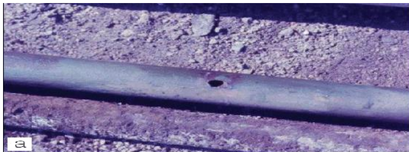
Figura 3: Corrosão eletrolítica em tubulação.
