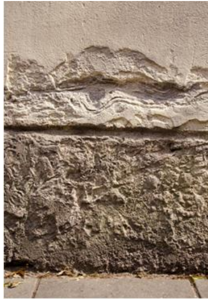
Figura 2: Corrosão química em concreto armado.
