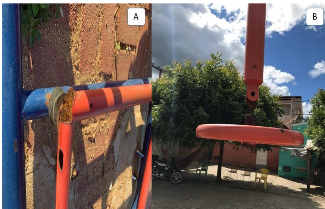
A) Corrosão por esfoliação e alveolar. B) Corrosão puntiforme, ou por pite e corrosão uniforme. Fonte: Autor (2020).
