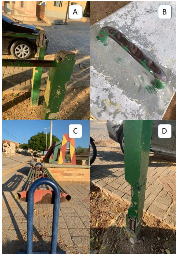
A) Estrutura de concreto com base no solo. B) Estrutura de concreto no solo. C) Banco de metal fixado no solo. D) Corrosão exposta em estrutura de concreto ligada ao solo.
