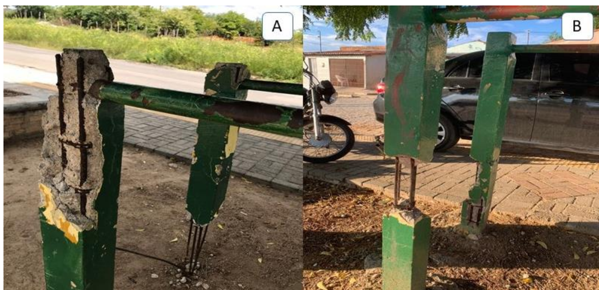
Figura 17: A) Corrosão uniforme na estrutura de alvenaria da praça pública. B) Corrosão no concreto armado.
