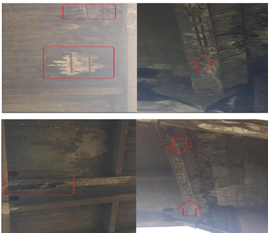
Figura 26 -Exposição da armadura presente na superestrutura
