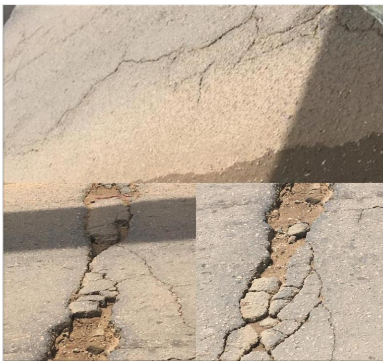
Figura 23 -Pista de rolamento apresentando irregularidades nas condições do asfalto.
