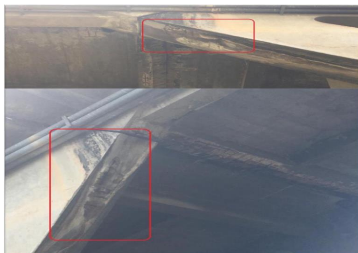
Figura 28- corrosão das armaduras presente nos pilares
