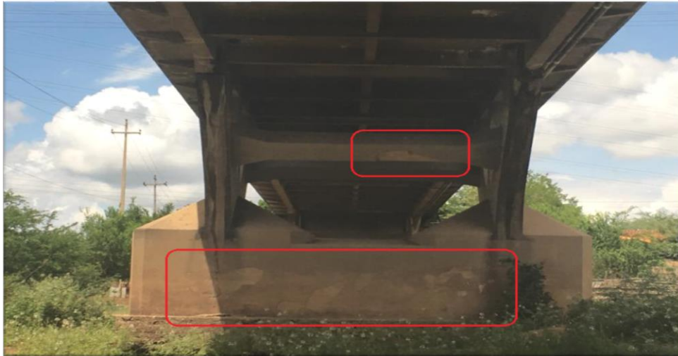
Figura 29- Deslocamento do concreto
