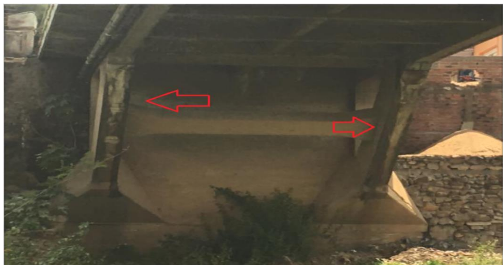
Figura 30- Efeito da eflorescência e das manchas no pilar
