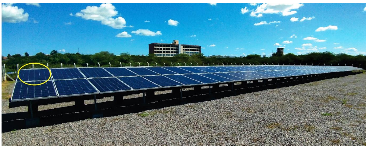
Figura 100: Local da instalação.
