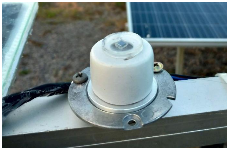
Figura 104: Estrutura de fixação do piranômetro de fotodiodo.
