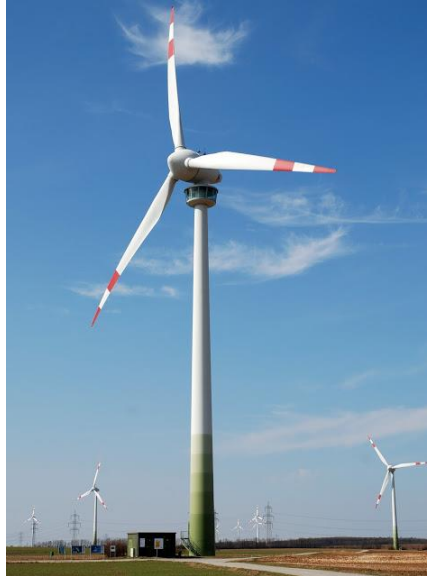
Figura 5: Aerogerador de eixo horizontal. Fonte: Blog da energia mecânica.
