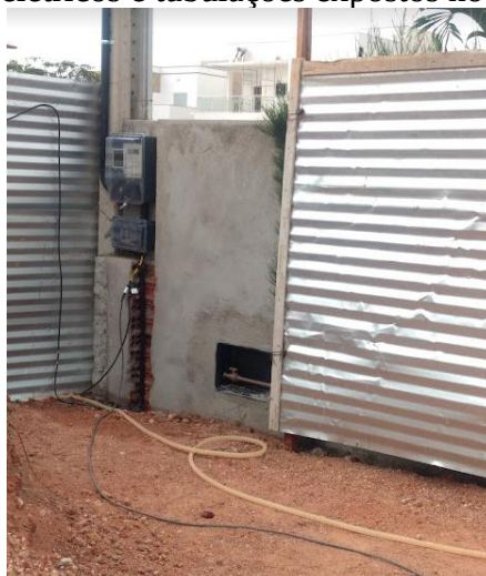
Figura 5: Cabos elétricos e tubulações expostos no canteiro de obras
