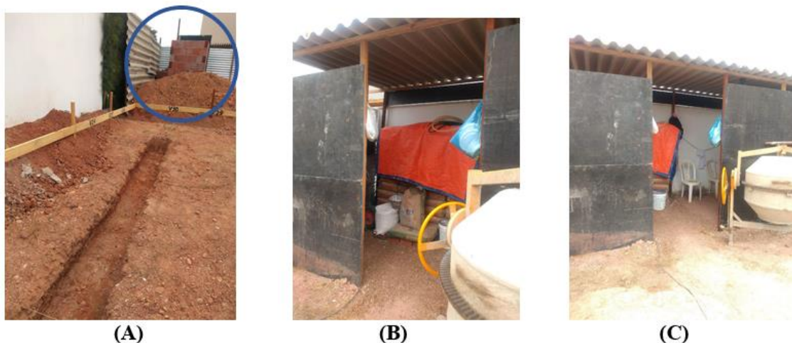
Figura 6: Falta de conformidade parcial em uma obra de pequeno porte
