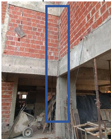
Figura 10: Fio precário utilizado para movimentação de vergalhões de aço
