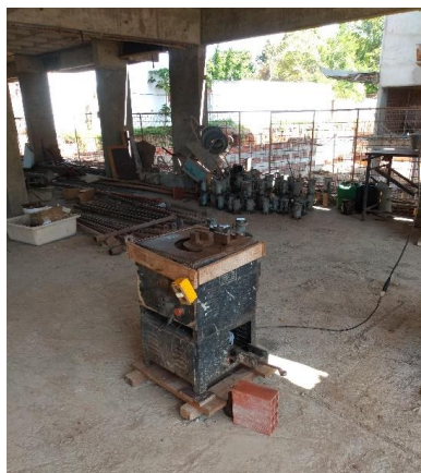
Figura 11: Local de instalação de máquina, com área de circulação sem a devida demarcação
