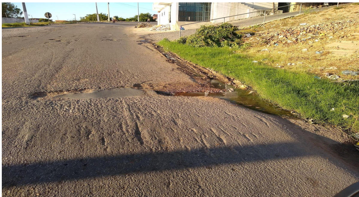
Figura 17 - Água residual empoçada às margens do pavimento.
