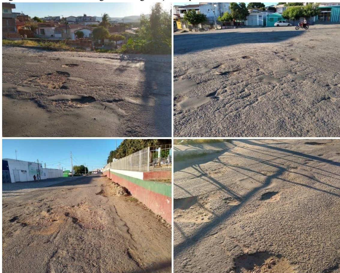
Figura 5: Mosaico de imagens da degradação do pavimento no trecho urbano.
