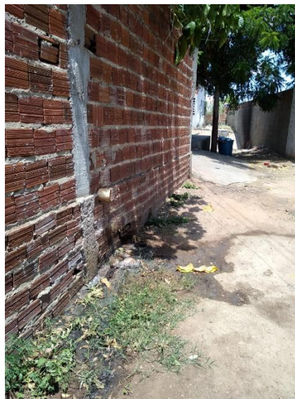
Figura 13 – Esgoto proveniente de residência no bairro Princesinha do Oeste sendo despejado a céu aberto
