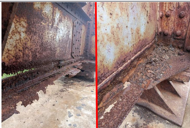
Figura 18. Oxidação com alto nível de desgaste. (Autoria própria)
