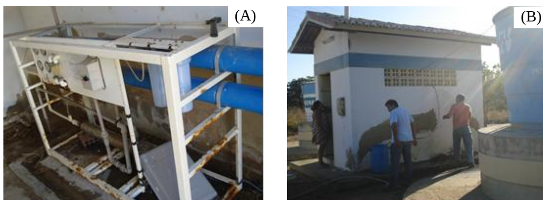
Figura 2 – Unidade de dessalinização (A) e local de coleta do rejeito da dessalinização (B) Fonte: Pesquisa de Campo, 2008 - 2010.
