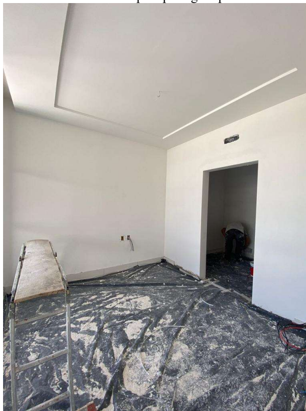
Figura 15 – Execução de forro de gesso posterior a execução de revestimento de piso em porcelanato, com revestimento de piso protegido por lona.
