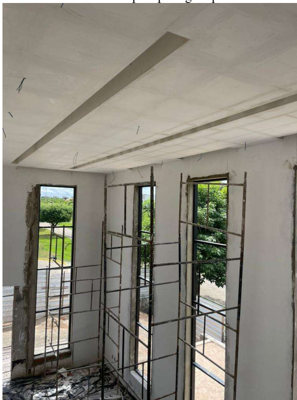
Figura 13 – Execução de forro de gesso posterior a execução de revestimento de piso em porcelanato, com revestimento de piso protegido por lona.
