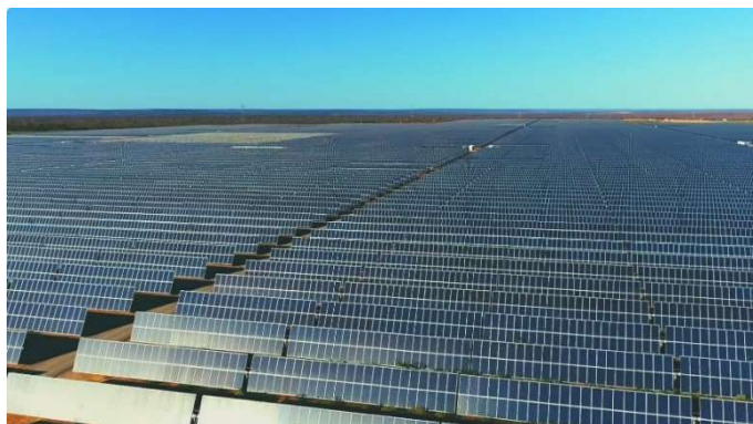
Figura 6. Parque Solar Nova Olinda [11].
