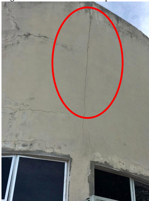
Figura 19: Fissura vertical no topo do lado D
