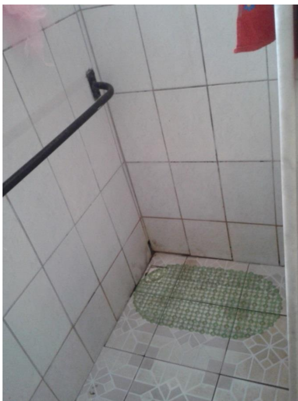
Figura 13: Chuveiro fora das condições acessíveis
