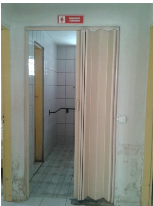
Figura 6: Sinalização incompleta nos banheiros
