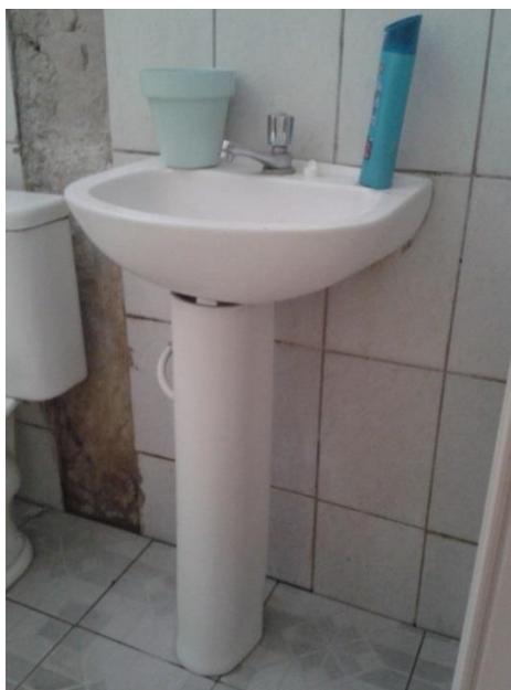
Figura 11: Lavatório sem barras de apoio e com maçaneta de giro
