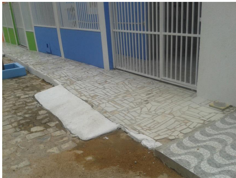
Figura 1: Calçada sem dimensões adequada e sinalização tátil.
