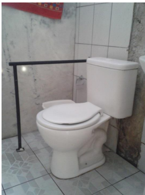
Figura 9: Vaso sanitário com barras de apoio inadequadas
