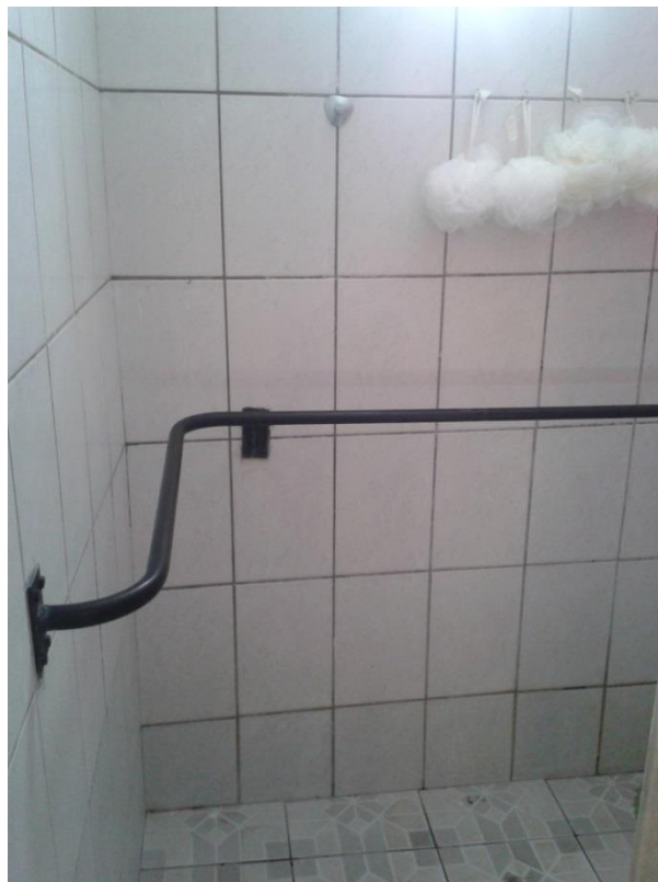
Figura 15: Barras de apoio inadequado no chuveiro
