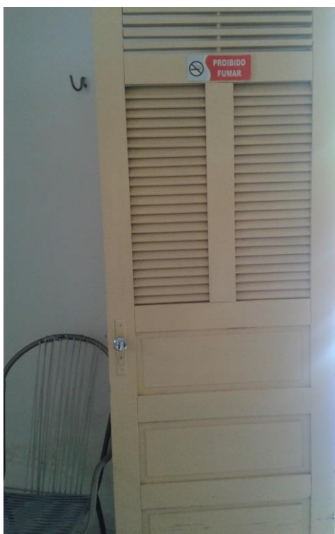
Figura 22: Porta de acesso à entrada com maçaneta de giro e sem revestimento inferior
