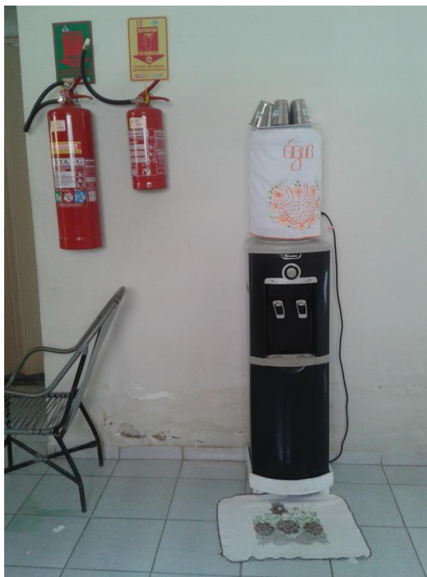
Figura 5: Sinalização incompleta nos extintores
