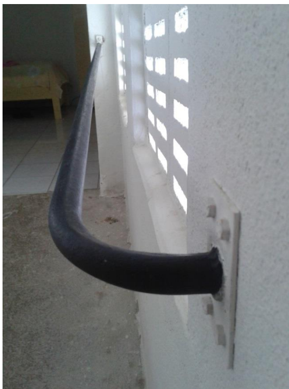
Figura 17: Corrimão com diâmetro e distância inadequados
