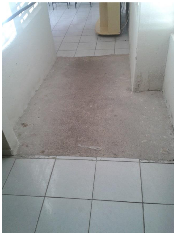
Figura 7: Rampas sem sinalização tátil no piso
