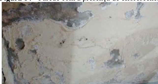
Figura 14 - Parede com a presença de eflorescência
