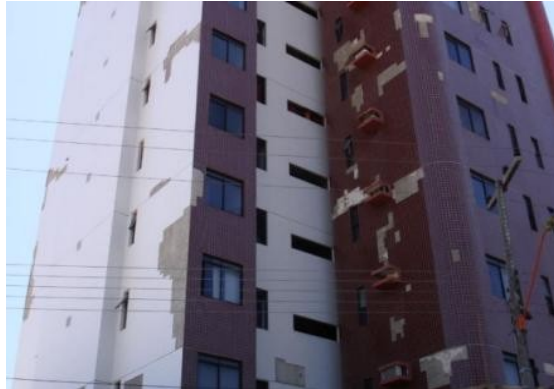
Figura 15 - Descolamento de revestimentos cerâmicos em fachada de prédio
