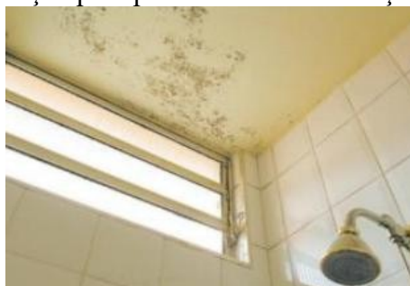
Figura 11 - Infiltração pelo processo de condensação em um banheiro
