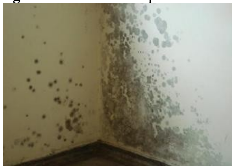
Figura 13 - Mofos em parede interna
