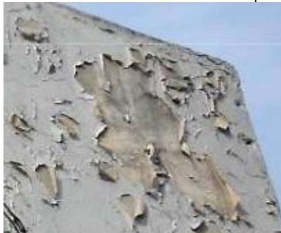
Figura 16 - Descascamento de revestimento em parede externa
