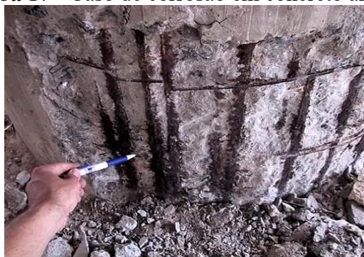
Figura 17 - Caso de corrosão em concreto armado
