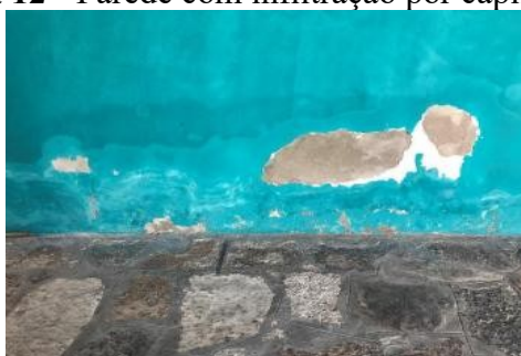
Figura 12 - Parede com infiltração por capilaridade
