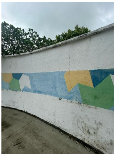
Figura 2 - Fissura e Infiltração (Autoria própria, 2025)
