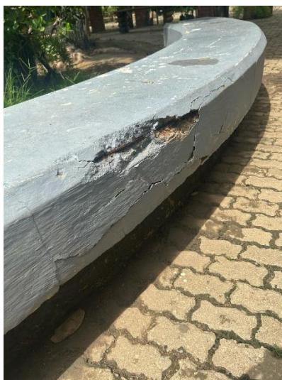
Figura 4— Corrosão de armadura em concreto armado (Autoria própria, 2025).
