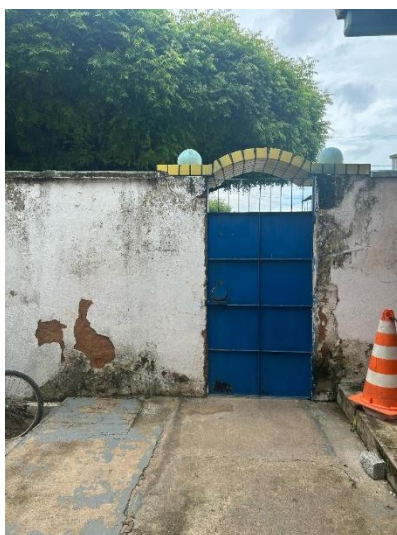
Figura 3– Infiltração; Descascamento da pintura e trincas; (Autoria própria, 2025).
