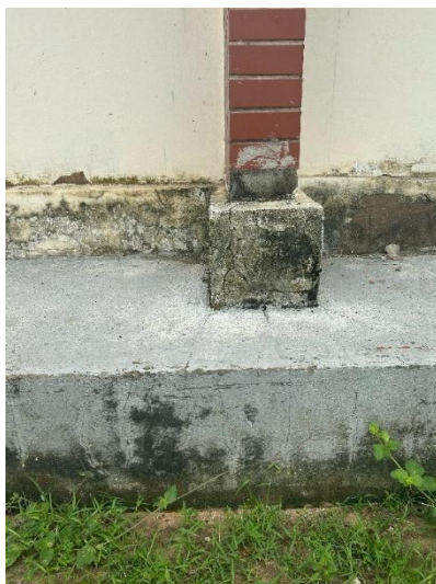
Figura 1 - Fissuras e Trincas (Autoria própria, 2025).
