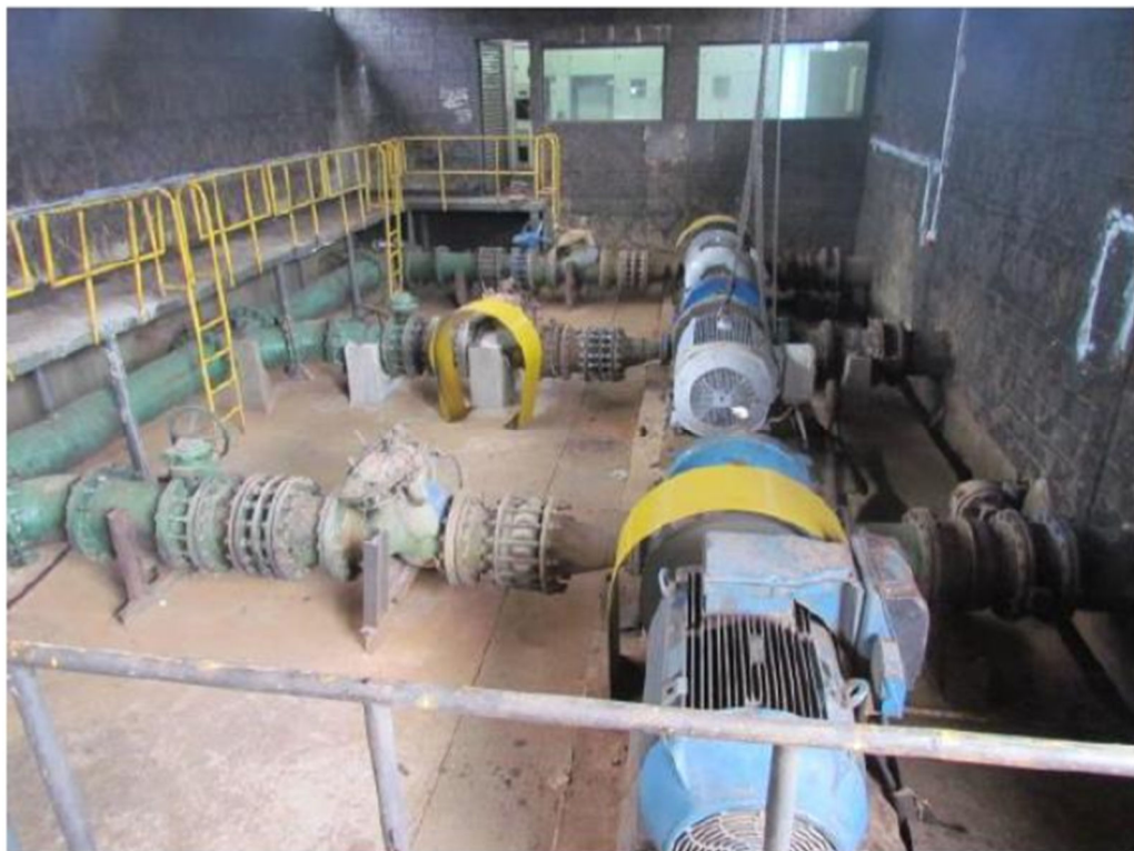
Figura 31: Motores Booster Rio Verde.
