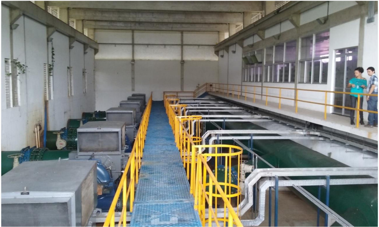
Figura 39: Estação Elevatória de Água Bruta de Pirapama.
