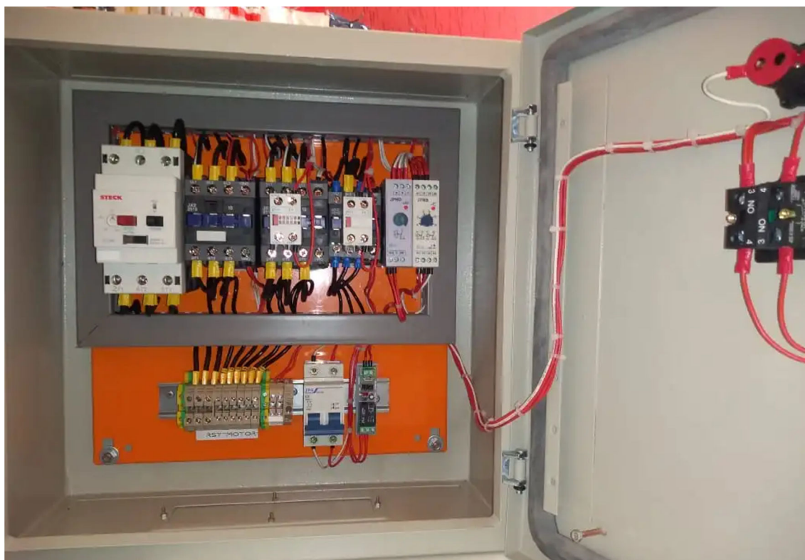
Figura 21: Quadro elétrico de partida estrela-triângulo.
