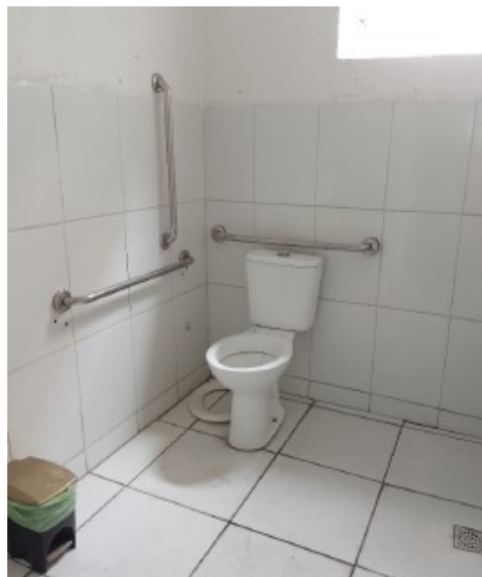
Foto 34 – Barra de apoio vertical instalada em local incorreto
