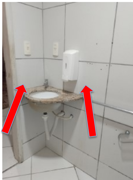
Foto 33 – Ausência de barra de apoio no lavatório
