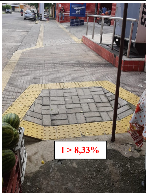
Foto 05 – Inclinação e largura inadequadas
