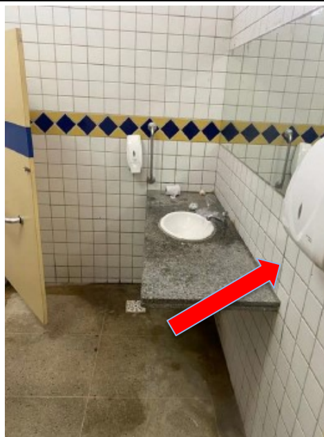
Foto 32 – Ausência de uma segunda barra de apoio no lavatório
