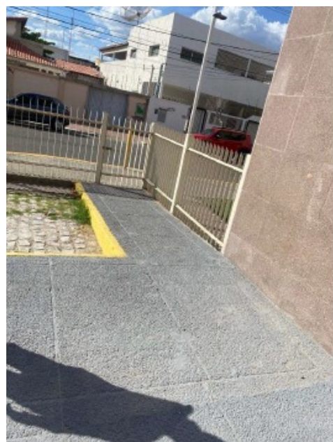
Foto 15 – Rampa de acesso sem piso tátil e corrimão
