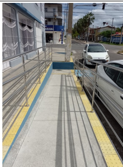
Foto 12 – Guarda corpo inadequado
