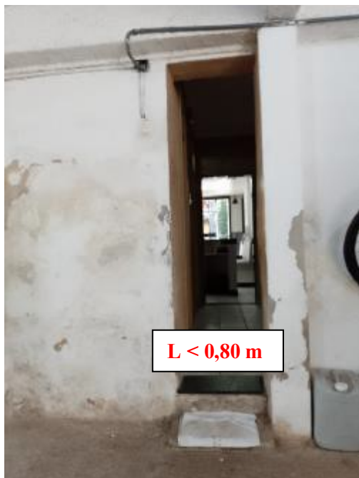
Foto 14 – Desnível irregular e vão livre inferior a 0,80 m
