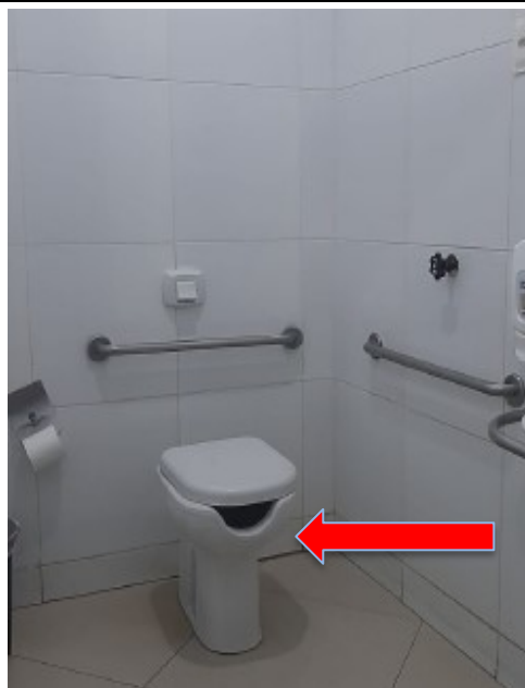
Foto 31 – Bacia sanitária não indicada pela norma
