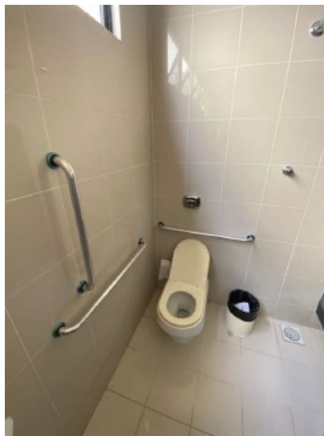
Foto 30 – Barras de apoio instaladas a uma altura diferente da preconizada pela norma
