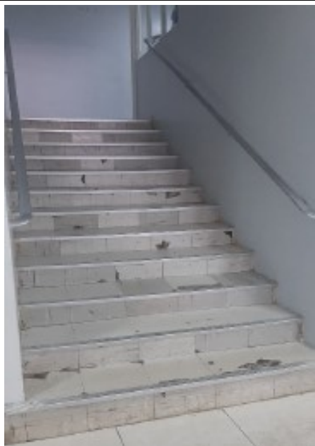
Foto 27 – Escada sem piso tátil de início e fim, além de corrimão instalado de maneira incorreta
