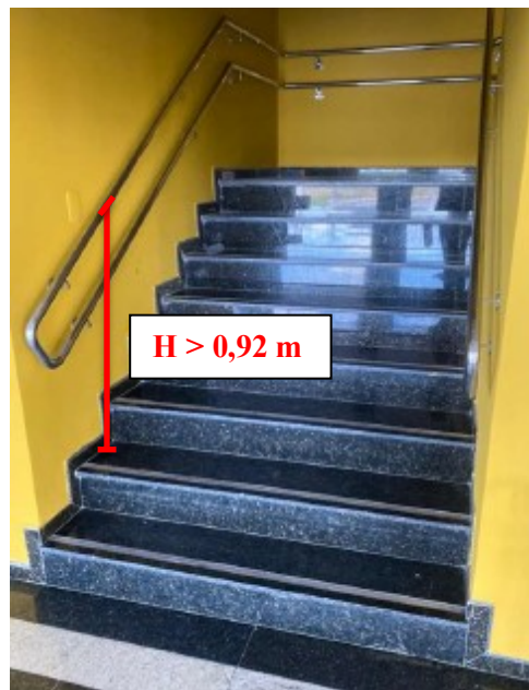
Foto 26 – Escada sem sinalização fotoluminescente e os corrimões estão instalados de forma incorreta
