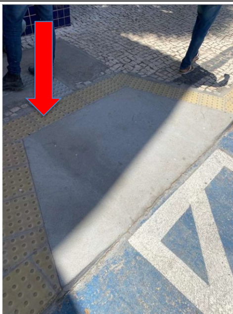
Foto 07 – Piso tátil instalado de maneira incorreta
