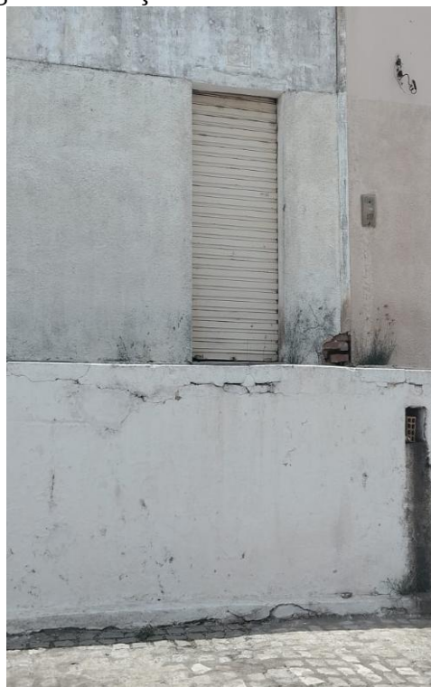
Figura 26- Calçada do entorno com fissuras
