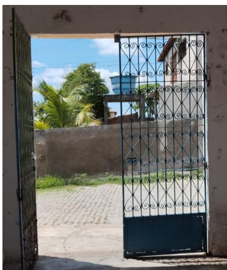
Figura 29- Portões de ferro das entradas
