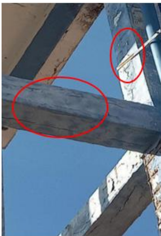
Figura 10 – Fissuras no reservatório
