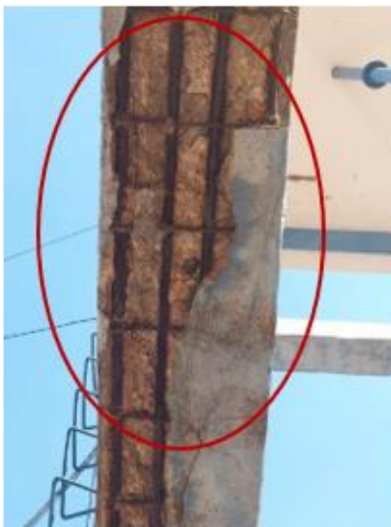
Figura 11 - Corrosão das armaduras
