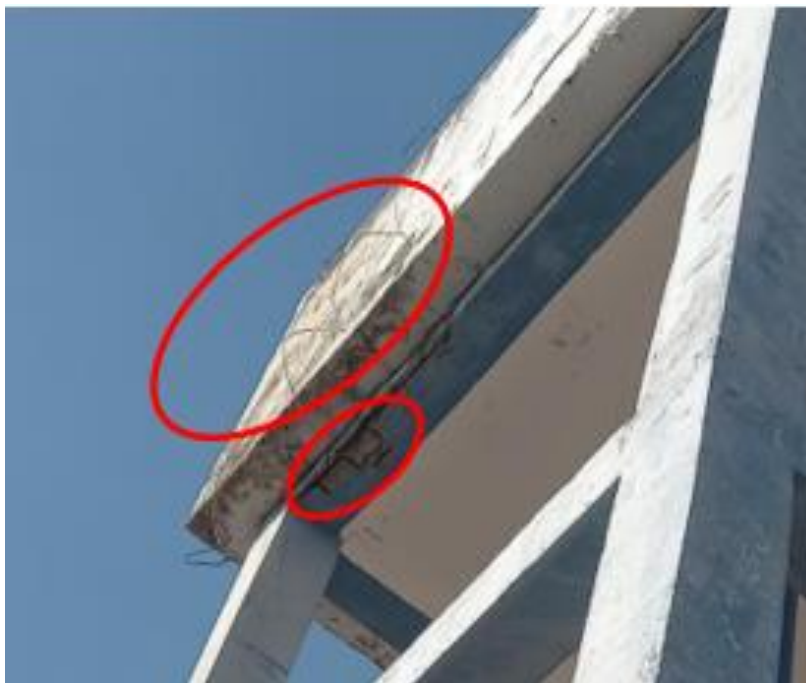
Figura 12 – Manchas pela umidade e eflorescência
