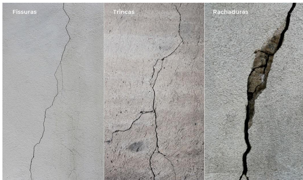
Figura 1 - Fissuras, trincas e rachaduras
