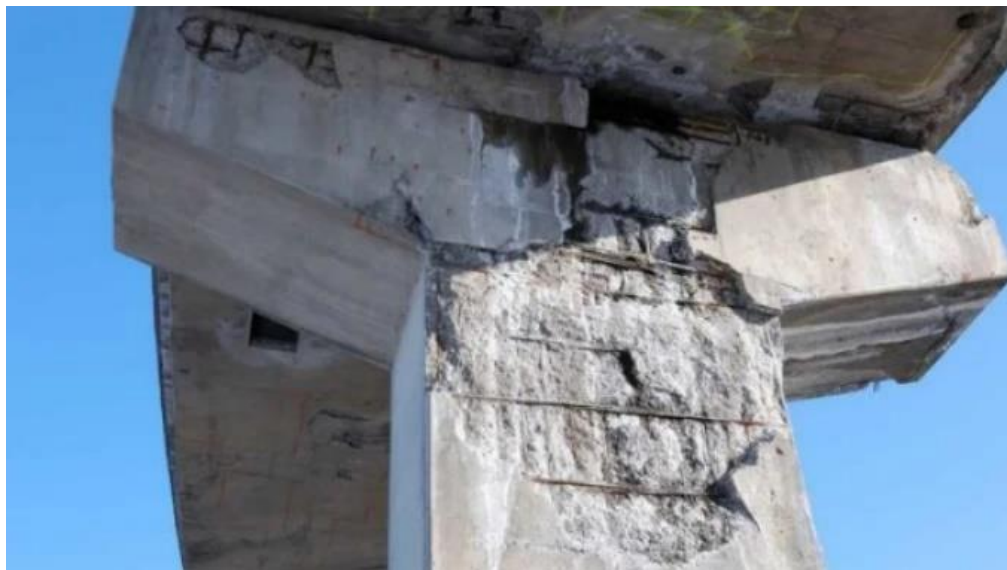
Figura 5 - Desagregação do concreto
