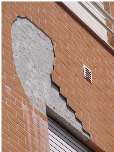
Figura 7 - Exemplo de destacamento de placas cerâmicas
