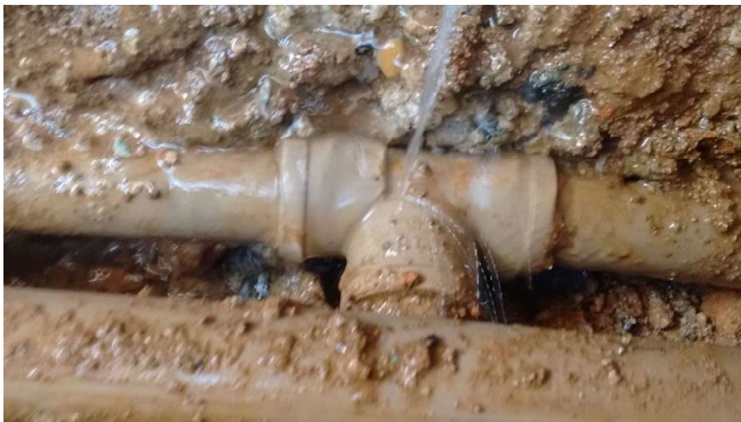
Figura 4 - Infiltração provocado por vazamento na rede hidráulica
