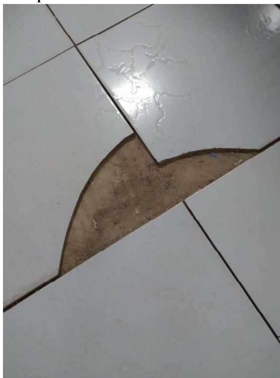
Figura 17 - Destacamento de placas cerâmicas na casa 1
