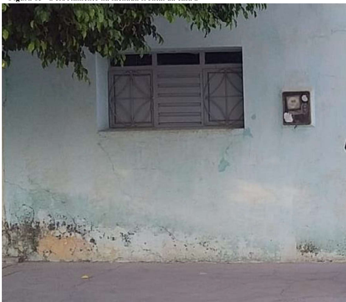
Figura 15 - Desbotamento na fachada frontal da casa 2
