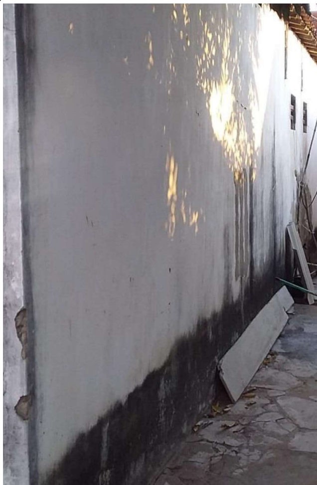
Figura 13 - Infiltração da casa 1
