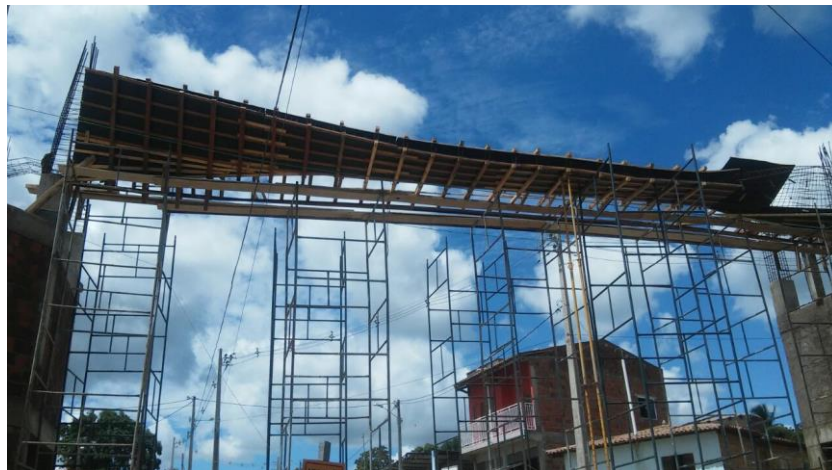
Figura 32: Estrutura de madeira tombada, após o acidente.
