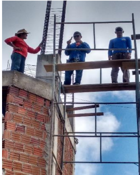
Figura 29: Trabalho sendo realizado sem a instalação de guarda-corpos.
