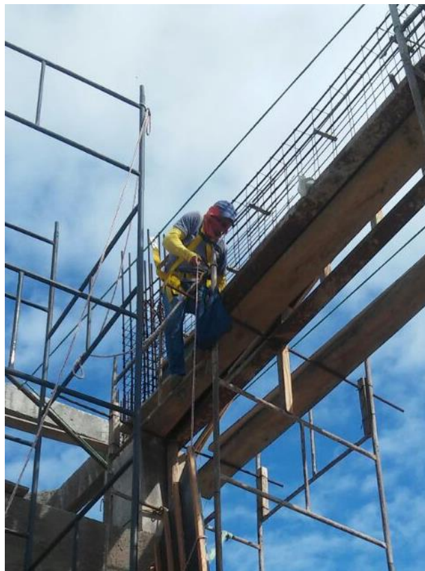
Figura 31: Trabalhador montando a estrutura antes do acidente.
