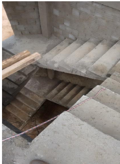
Figura 30: Escadas sem a instalação de proteção de guarda-corpos.
