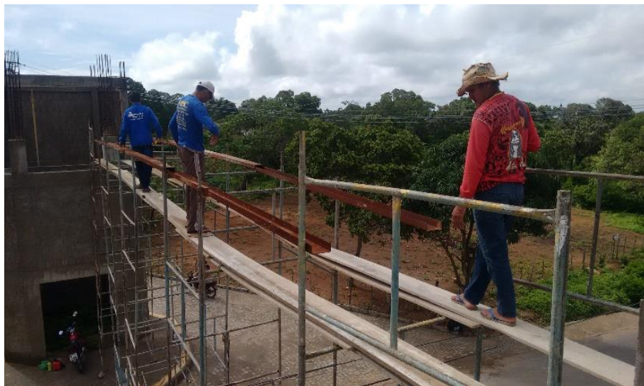
Figura 27: Trabalhadores realizando atividades sem total uso de equipamento de proteção.
