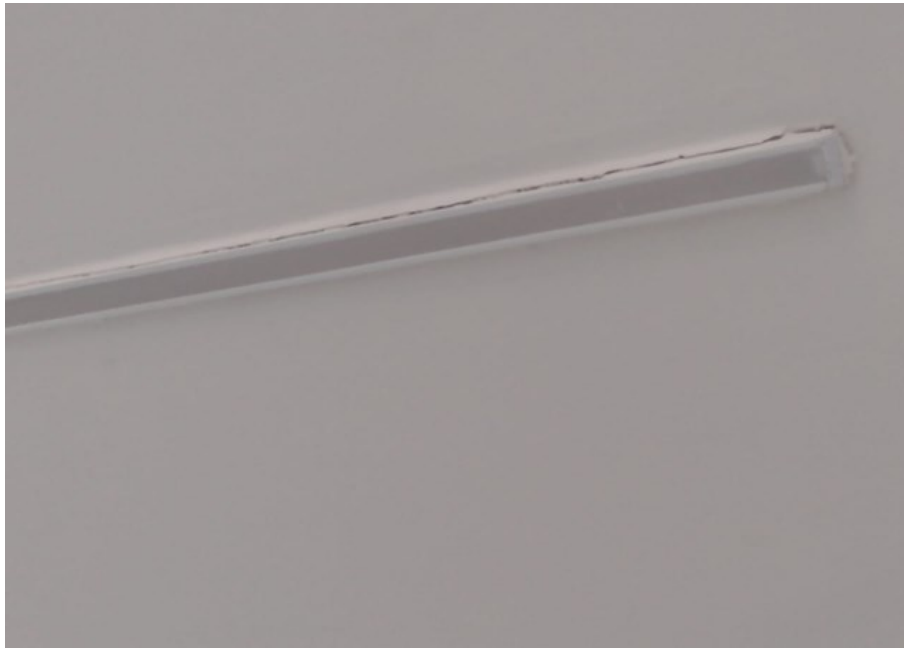
Figura 8 – Desplacamento de gesso
