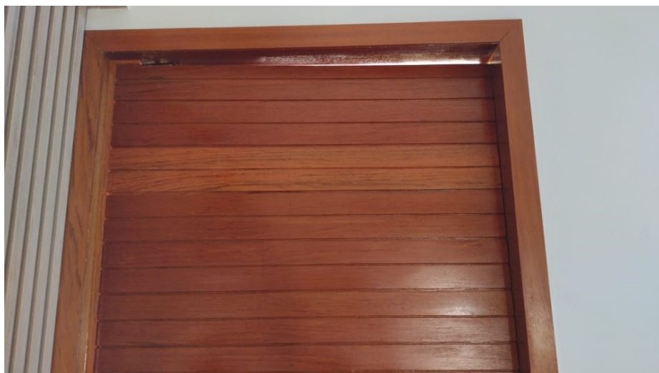
Figura 9 – Caixa de porta desalinhada
