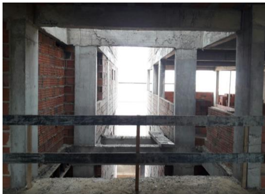
Figura 16 - Incorreta sinalização de áreas de risco no R3.
