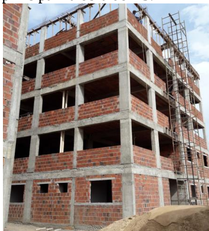
Figura 25 - Ausência da plataforma de proteção (bandeja) principal na obra do R3.
