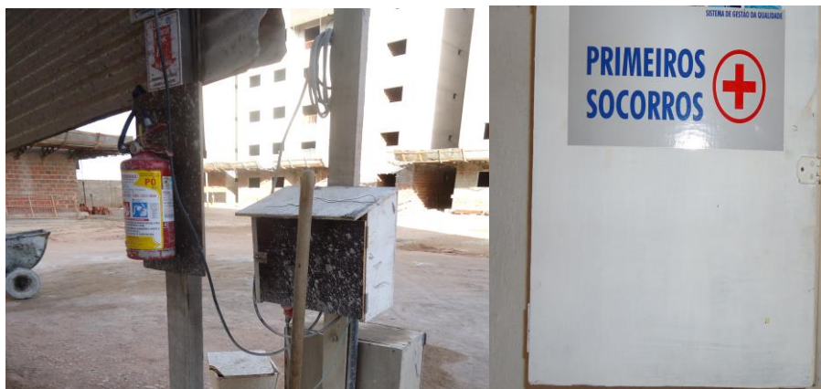
Figura 27 - Extintor de incêndio próximo a materiais elétricos e/ou inflamáveis e a presença de kit de primeiros socorros no almoxarifado da CB.
