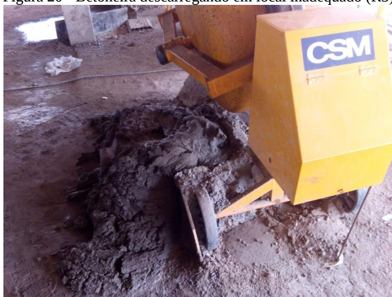
Figura 20 - Betoneira descarregando em local inadequado (R3).
