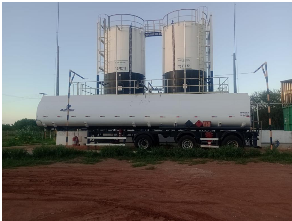
Figura 16 - Tanques para especificação do óleo e carreta para transporte.
