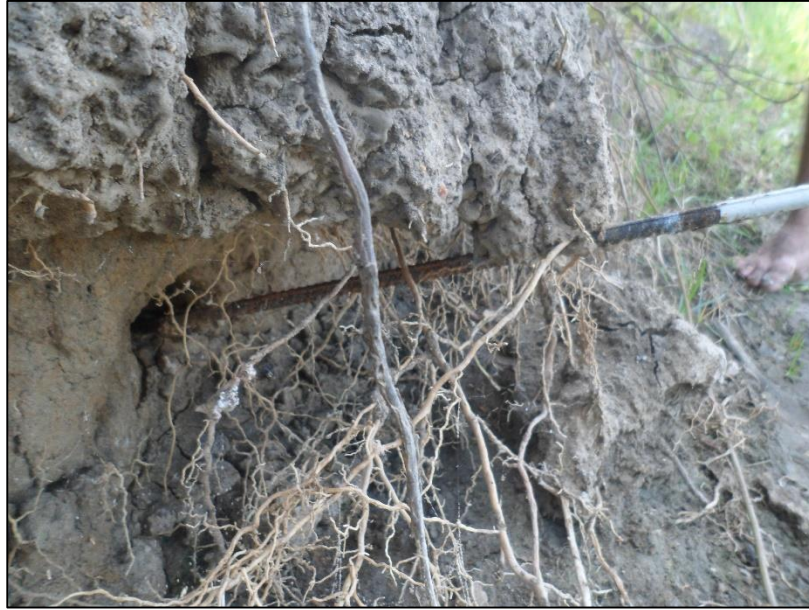
Figura 30 - Processo de Corrosão da margem.
