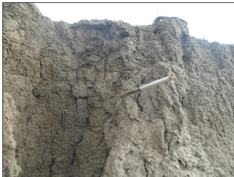
Figura 29 – Ação do escoamento superficial da água da chuva, formação de voçorocas na margem.
