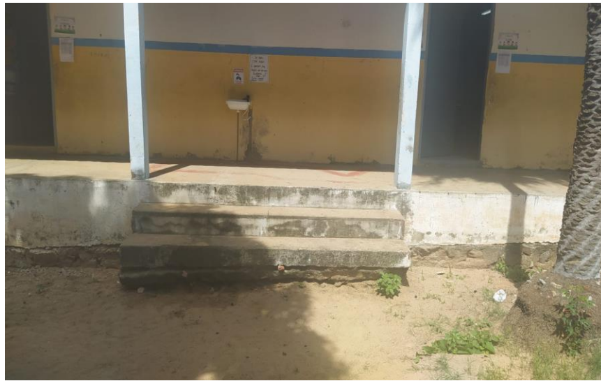
Figura 33 – Desnível do bloco 3 onde funciona duas salas de aula – Escola Municipal Tulipas.
