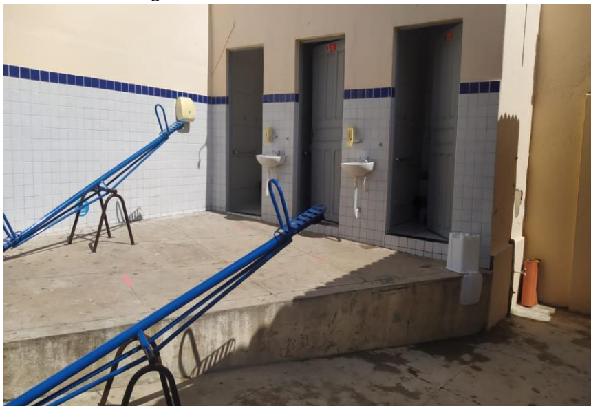
Figura 16 – Desníveis dos banheiros infantis.
