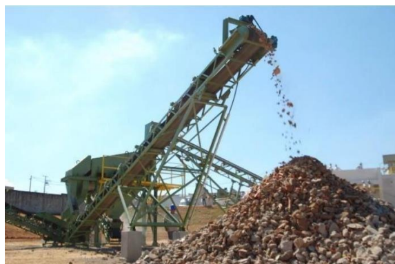
Figura 3: Usina de RCD Móvel.
