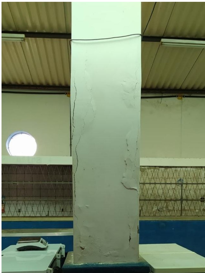
Figura 14. Expansão do pilar acompanhado de fissuras.
