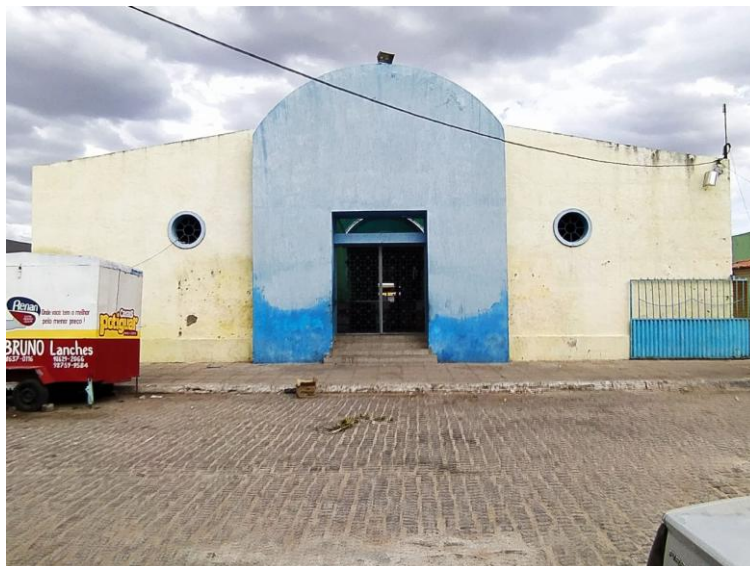
Figura 18. Sujidade e mofo em fachada do Mercado Público.
