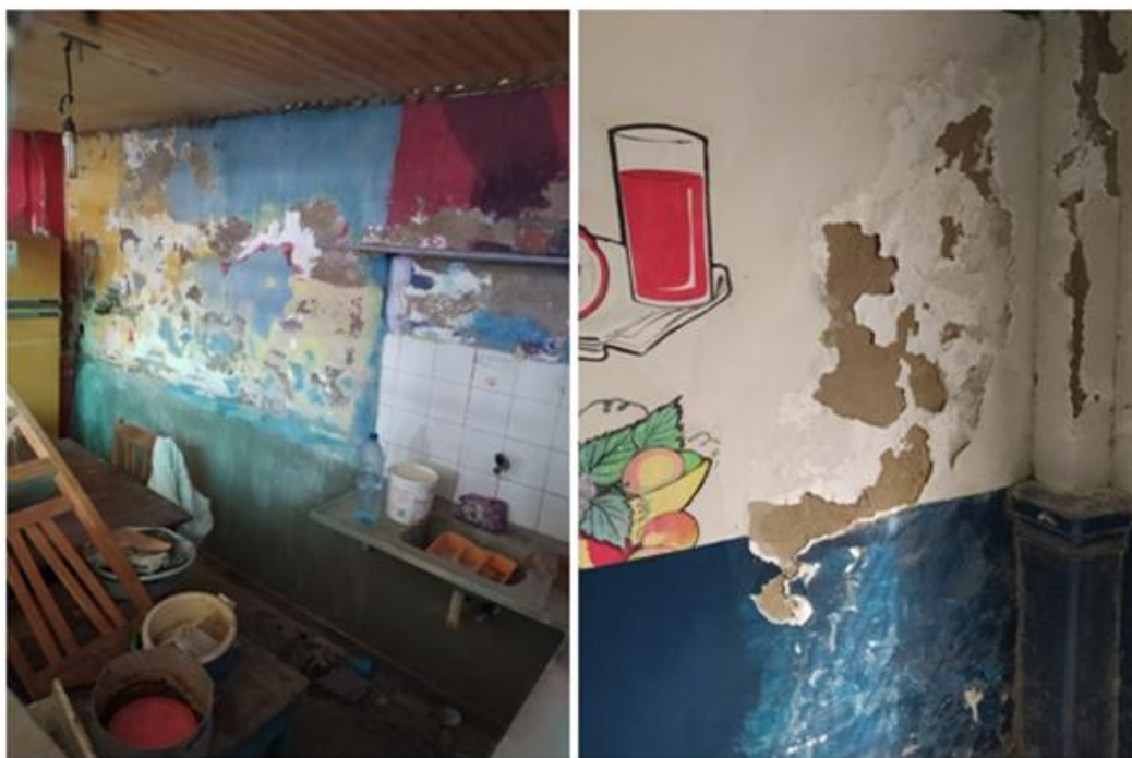
Figura 15. Destacamento do revestimento
