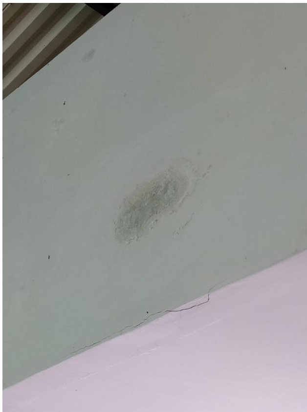
Figura 17. Mofo no reservatório de água.
