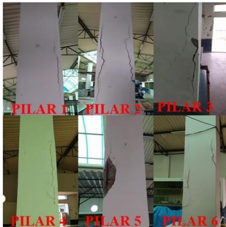
Figura 11. Pilares que apresentam fissuras.
