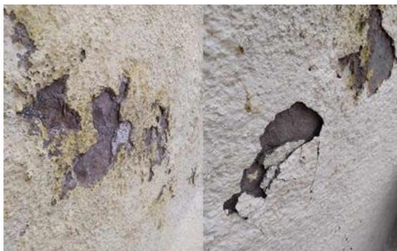
Figura 16. Destacamento do revestimento externo
