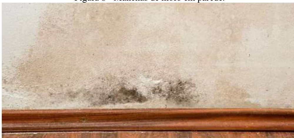
Figura 8 - Manchas de mofo em parede.
