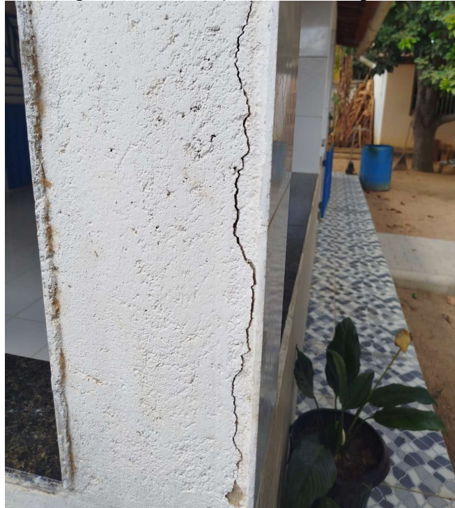
Figura 24 - Presença de trinca em pilar.
