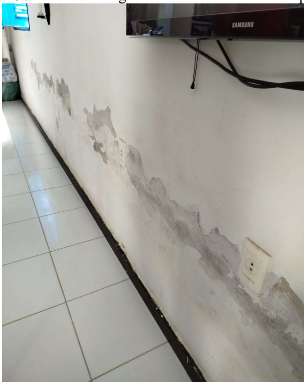
Figura 30 - Umidade degradando toda a extensão da parede.
