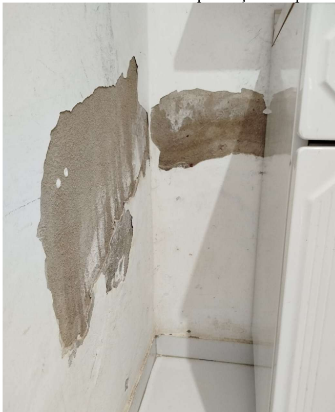
Figura 29 - Descolamento do reboco e presença de criptoflorescência.
