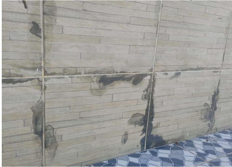
Figura 22 - Manchas de umidade em revestimento da parede externa.
