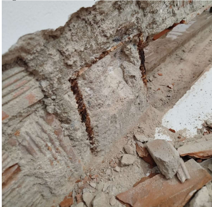
Figura 26 - Armadura apresentando sinais de corrosão.
