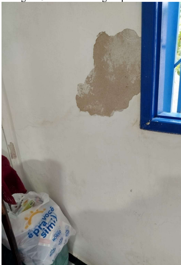
Figura 31 – Altura atingida pela umidade.
