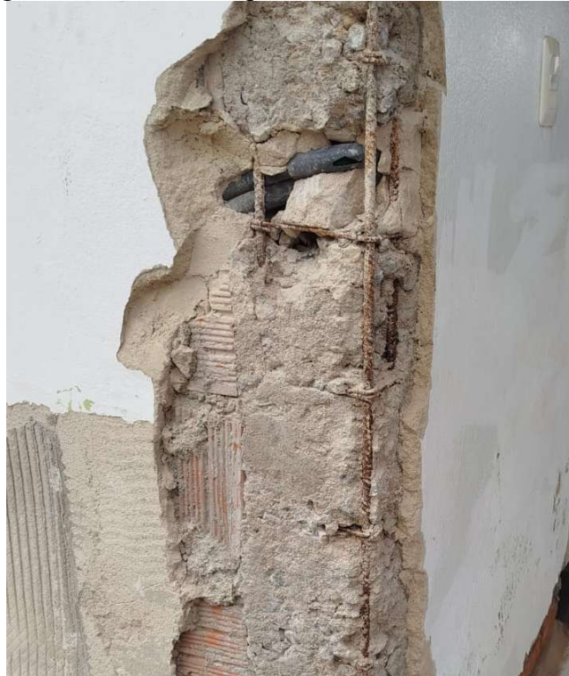
Figura 25 - Armadura apresentando sinais de corrosão.
