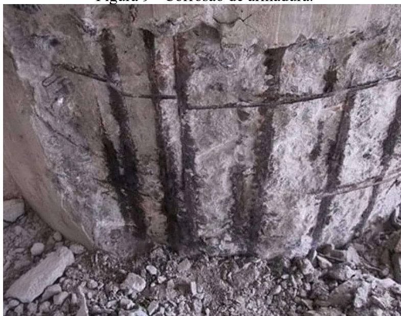
Figura 9 - Corrosão de armadura.
