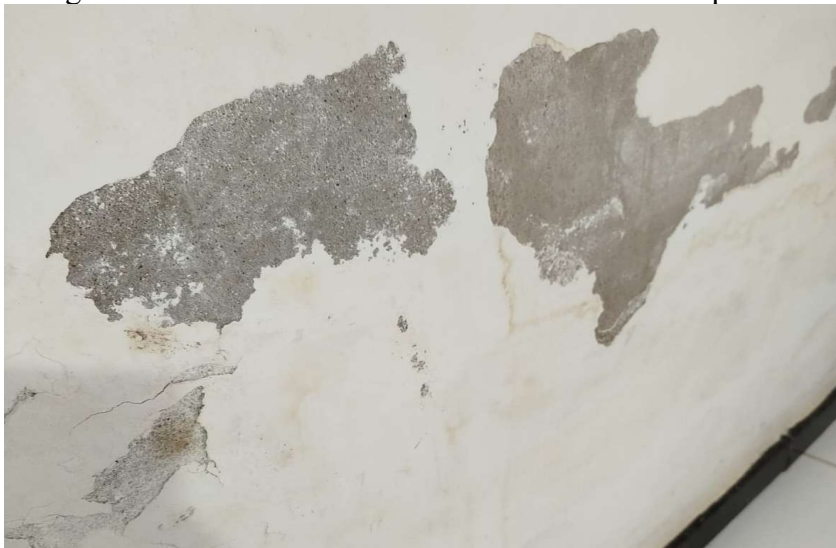
Figura 28 - Parede com manchas e descolamento de pintura.
