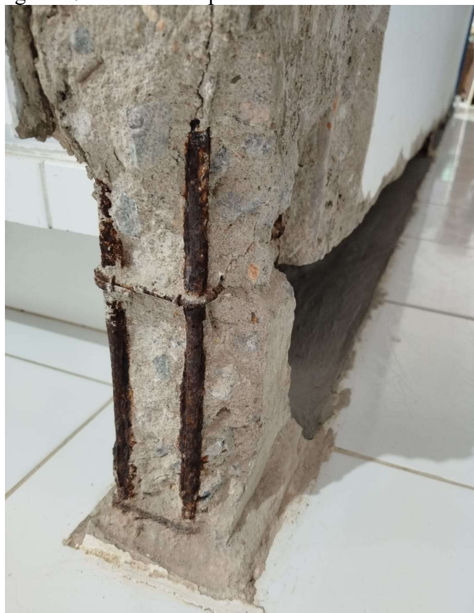
Figura 27 - Armadura apresentando sinais de corrosão.
