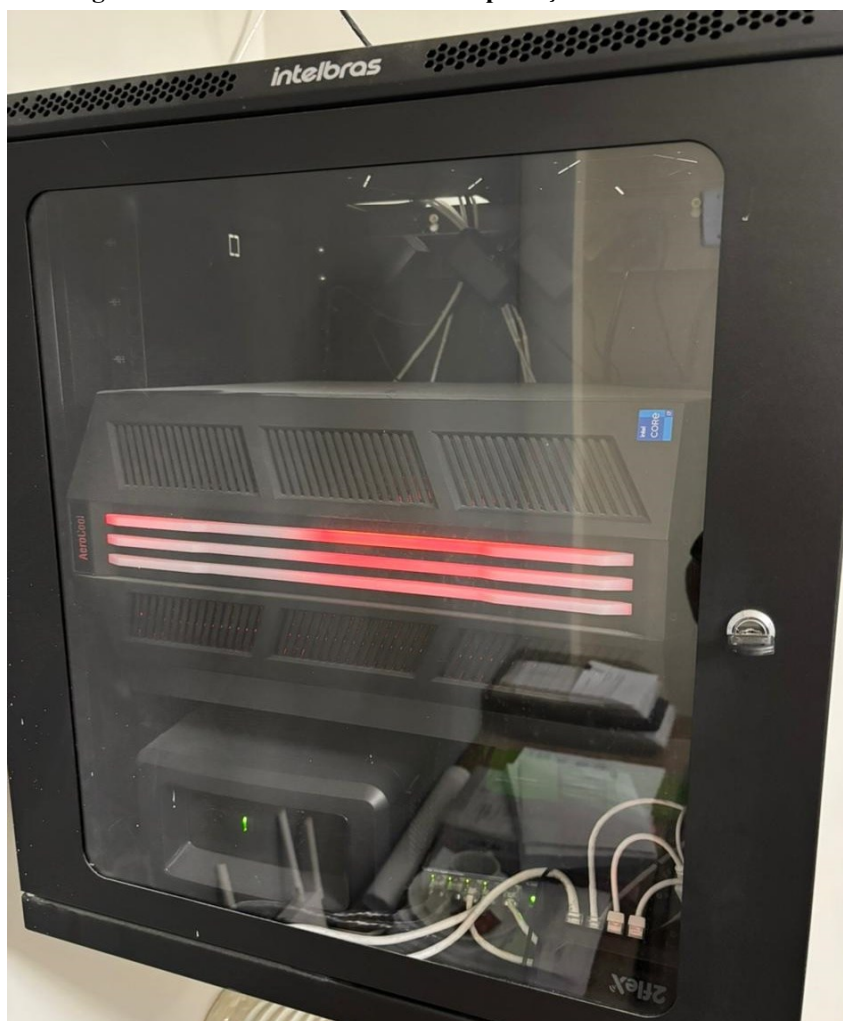
Figura 8 – Servidor da unidade com proteção elétrica dedicada.
