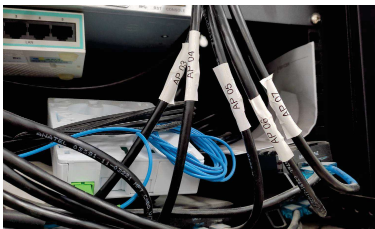
Figura 18 - Destaque para os cabos ethernet dos access points .
