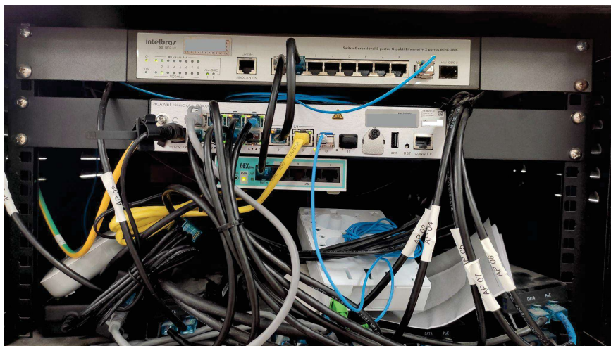
Figura 17 - Equipamentos do rack de TI do provedor de Internet.
