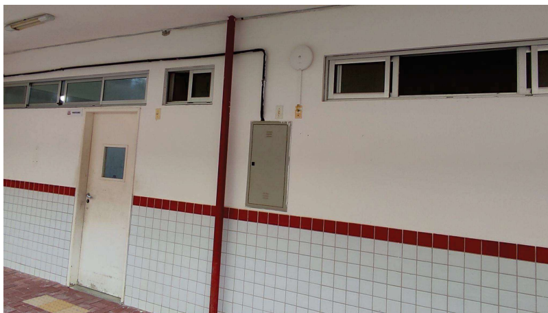
Figura 05 - Access point de uso interno, fixado em frente a Sala dos Professores.
