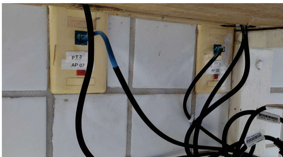
Figura 20 - Portas de rede da parede ocupadas com cabos dos access point .
