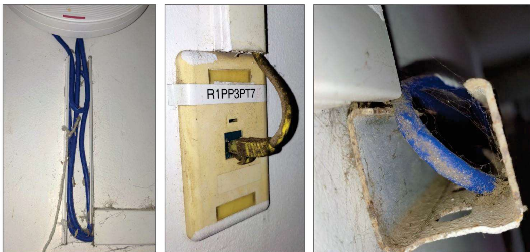
Figura 06 - Desgaste dos cabos ethernet dos access point instalados nos corredores.
